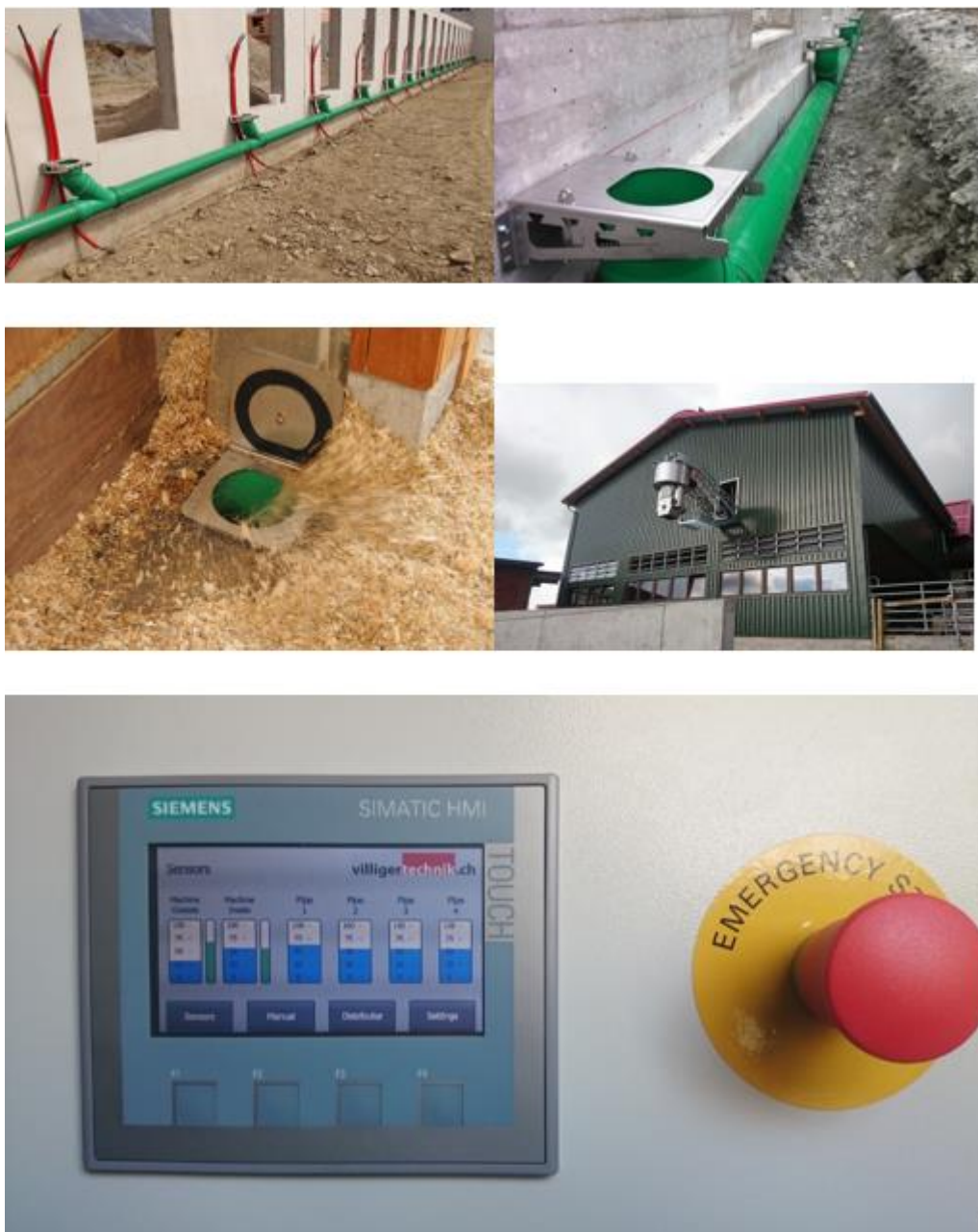
Figur 4: Exempel på en modell av utgödsling där gödseln sugas med luft från boxen via rör installerade under stallgolvet och vidare rakt ut till gödselstaden © villingertechnik.ch
