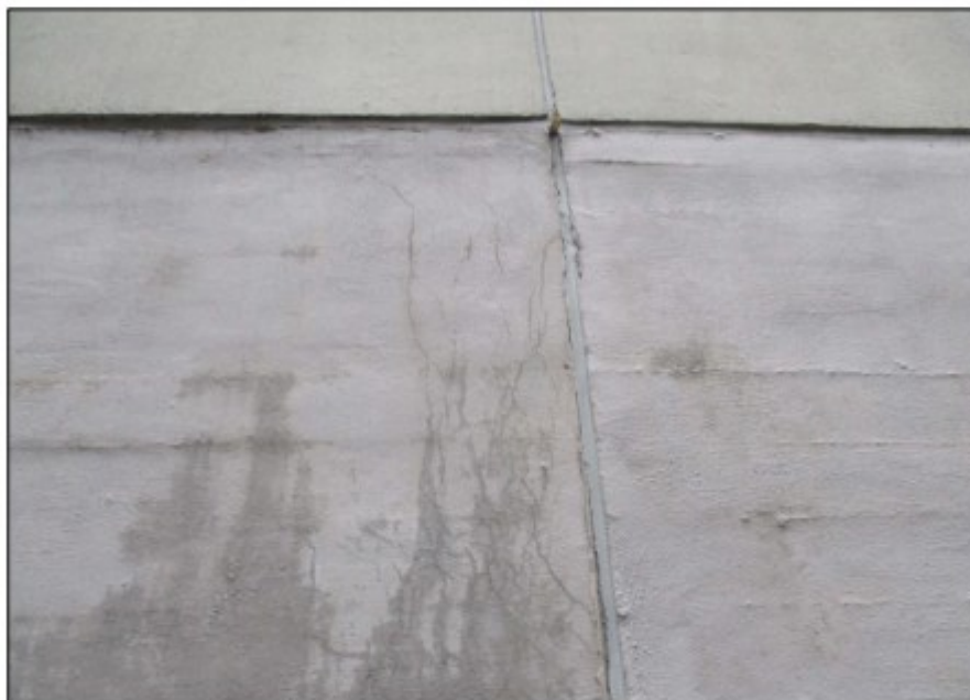
Kuva 3. Betonin pakkasrapautuminen julkisivussa. [7.]
