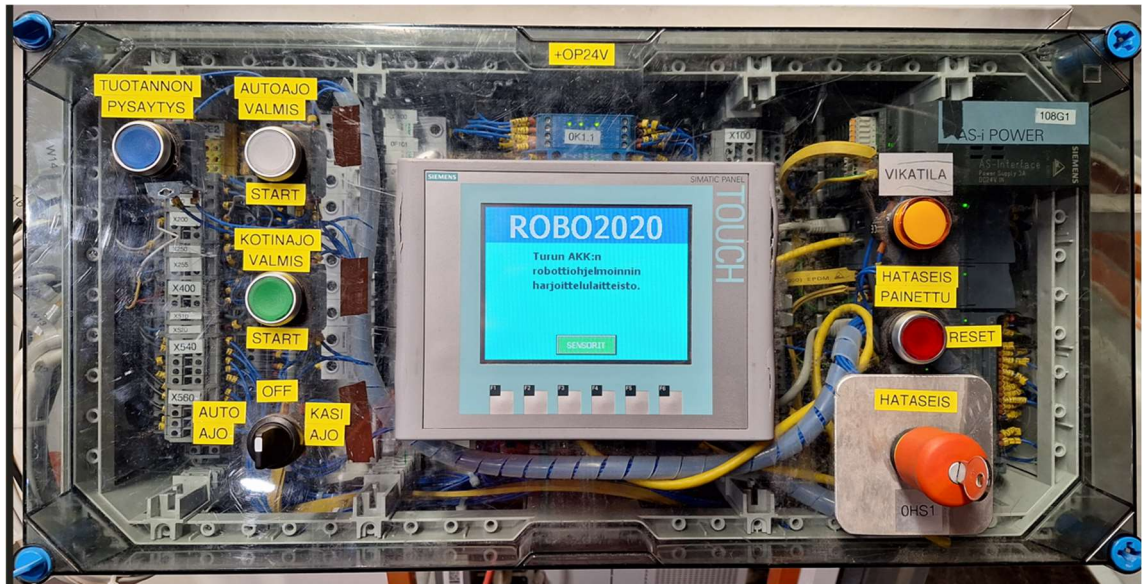
Kuva 30. Logiikkajärjestelmän ohjauskeskus. (Oma kuvakokoelma)
