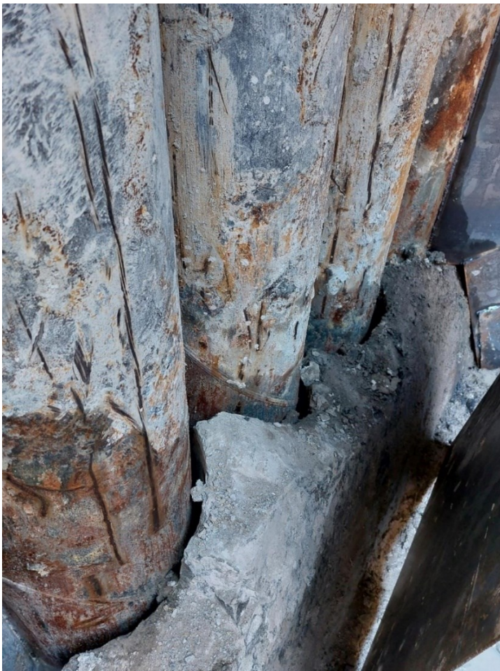
Kuva 15. Porapaaluseinän ja kallion liitoksen injektoimaton vuotokohta
