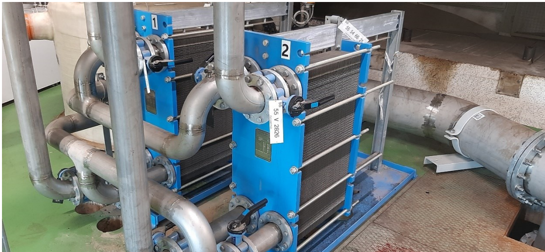
Kuva 6. G2 generaattorin laakereiden jäähdytyksen lämmönvaihtimet.
