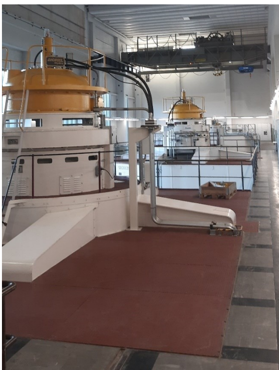
Kuva 2. Harjavallan vesivoimalaitoksen koneet.
