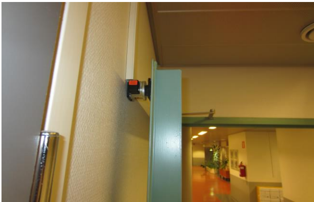
Kuva 14. Sähkömagneettinen oven salpa.
