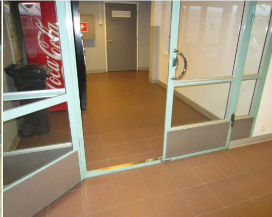
Kuva 13. Hissiin johtavan oven kynnyks.,
