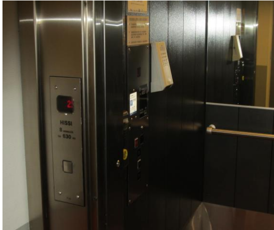
Kuva 16. Hissi ulkopuolelta kuvattuna
