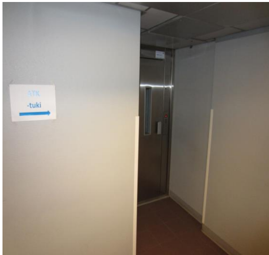
Kuva 18. Hissin opastus puuttuu
