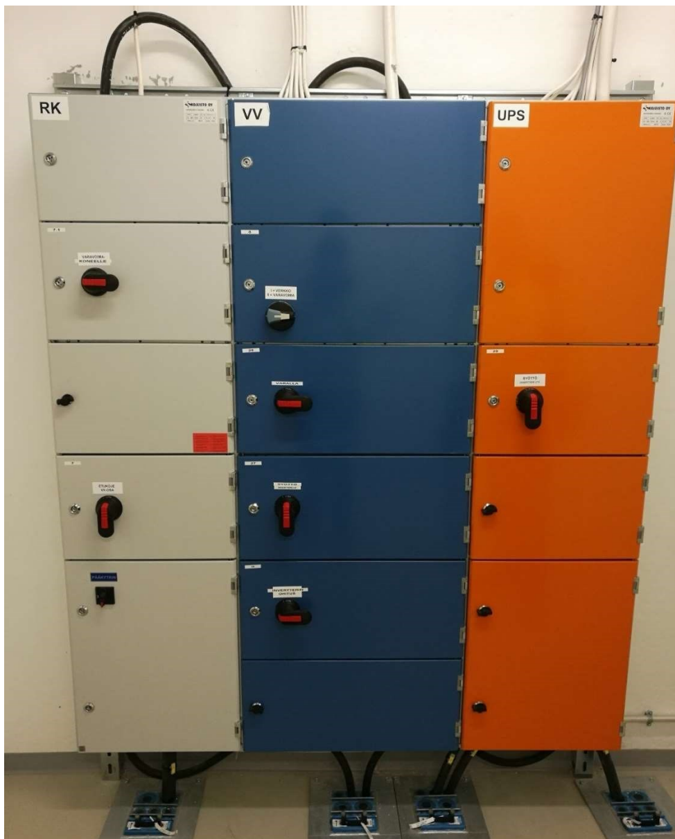
Kuva 5. Normaali- (vasemmalla), varavoima- (keskellä, alle 15 s) ja UPS-keskus (oikealla) vierekkäin [9, s. 13].
