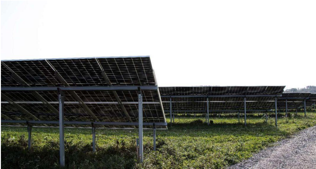
Figur 16. Baksidan av tvåsidiga solceller i en solcellspark.
