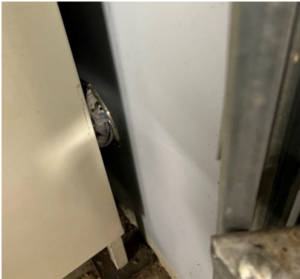
Kuva 19. Autotallin alempi ilmanvaihtosäleikkö
