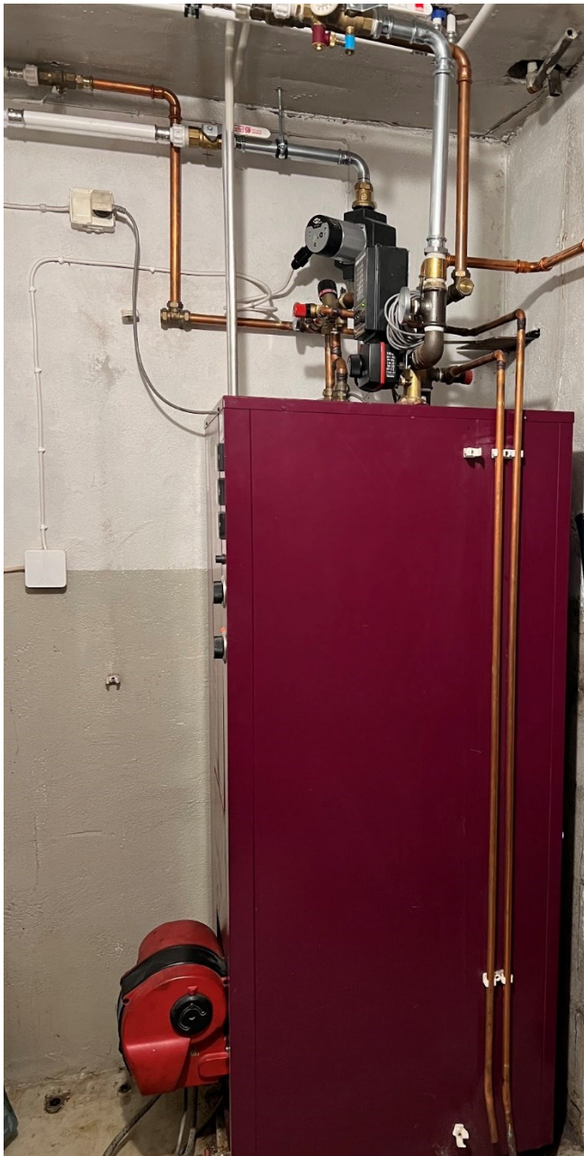
Kuva 13. Öljypoltin ja öljykattila
