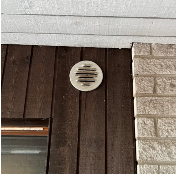
Kuva 18. Autotallin ylempi ilmanvaihtosäleikkö
