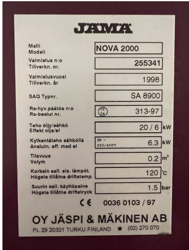
Kuva 14. Öljykattilan teknisiä tietoja
