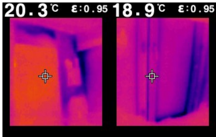
Kuva 26. Keittiön tuloilman putki ja alakerran makuuhuoneen ikkuna
