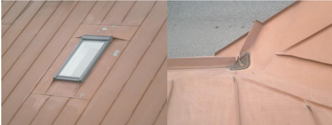
Kuva 3. ja Kuva 4. Kattoikkunan ympärillä selvää maalin hilseilyä ja lammikointumista jalkarännien liitoskohdassa.
