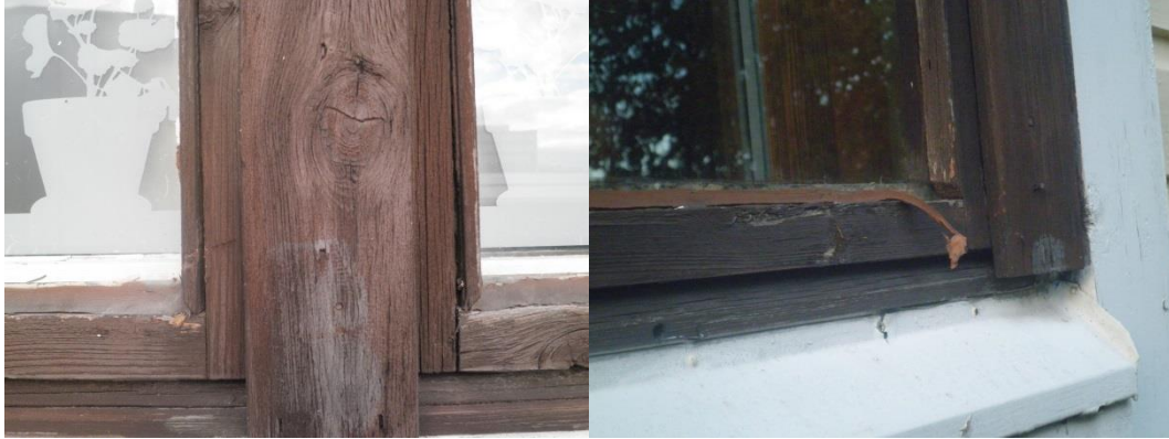
Kuva 12. ja Kuva 13. Ikkunan puuosien ja kyntteiden rapistumista.
