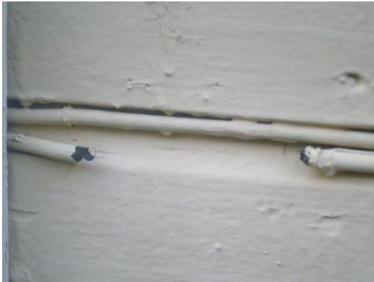
Kuva 14. Käytöstä poistuneita sähköjohtoja talon julkisivulla.
