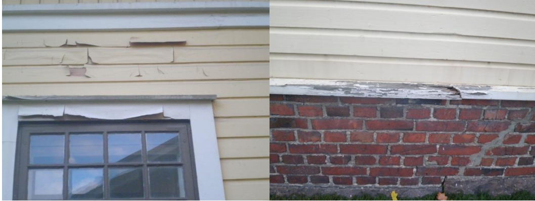
Kuva 8. ja Kuva 9. Julkisivun maalikalvon hilseilyä ja sokkelin päällä olevien tippalistojen lahovaurioita.
