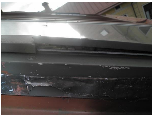
Kuva 5. Kattoikkunan rikkoutunut reunapelti.
