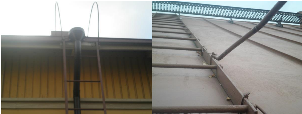
Kuva 6. ja Kuva 7. Talotikkaiden väliin asennettu syöksyränni ja johteen kyseenalainen kiinnitys lapetikkaaseen.
