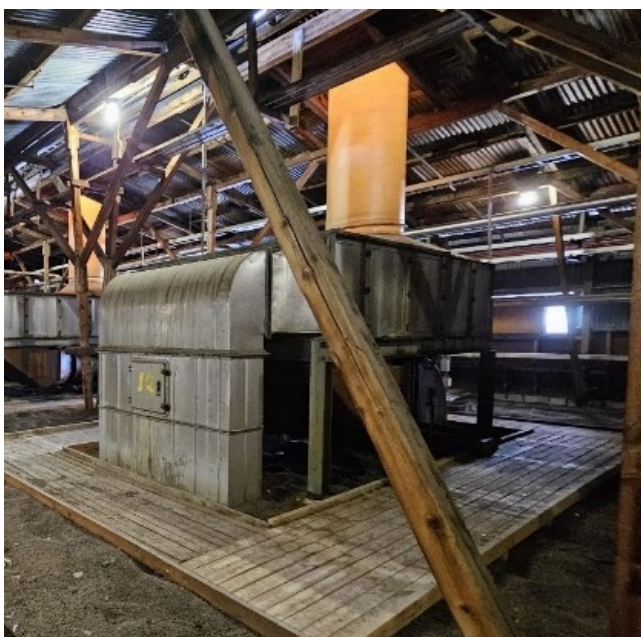
Kuva 11. Kuvassa lämmönvaihdivärjestelmä kuivaamon ullakolta (Kuva: Valtteri Pennanen).
