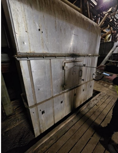
Kuva 22. Lämmönvaihtimelta takaisin uuniin menevän ilman näytteenottopiste (Kuva: Valtteri Pennanen).
