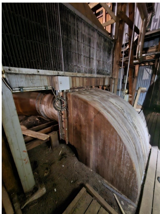
Kuva 24. Uunista tuleva kaareva ilmakanava lämmönvaihtimelle, josta mittaukset otettiin (Kuva: Valtteri Pennanen).
