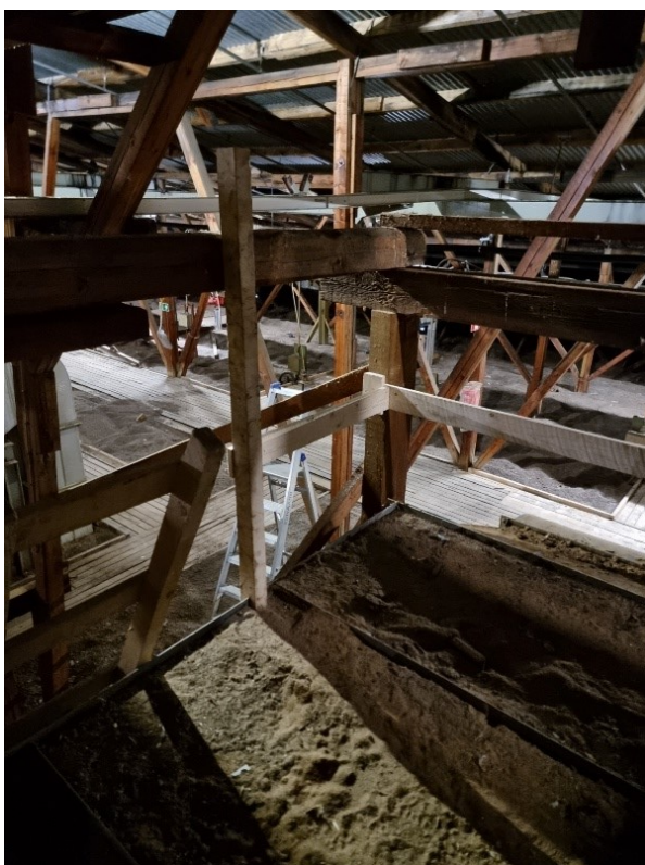
Kuva 21. Mittauspaikalle rakennetut turvakaiteet (Kuva: Roope Ylimaula).
