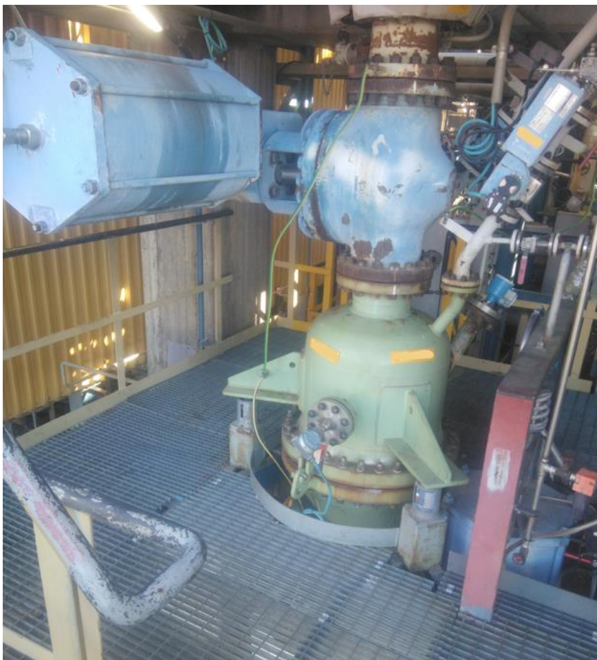
Kuva 15. Kohteen toimilaitte ja venttiili ovat erittäin suurikokoisia.
