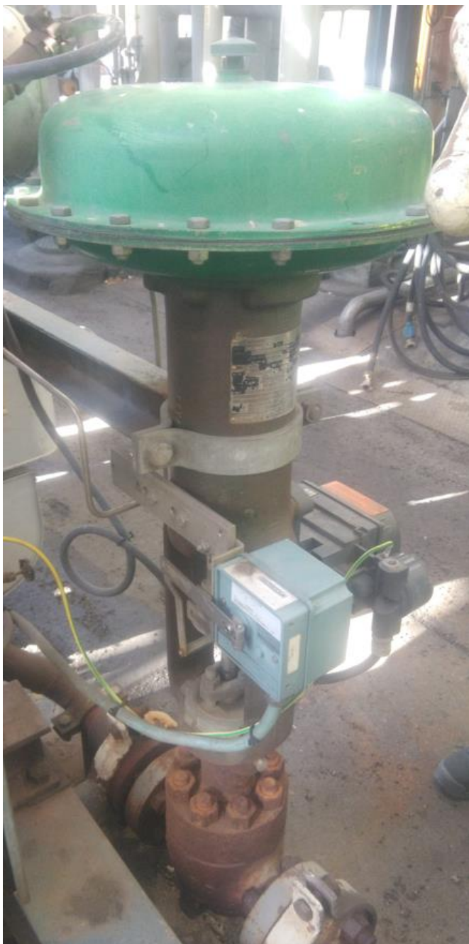
Kuva 17. Kohteen 6 toimilaitte, asennoitin, erillinen mekaaninen asentomittaus ja istukkaventtiili alhaalla linjassa laippaliitoksilla.
