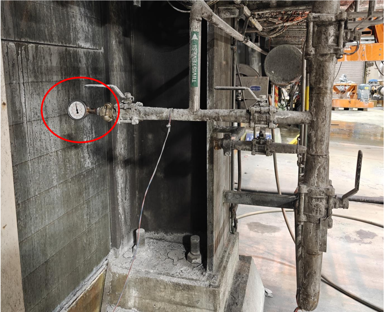
Kuva 26 Jakotukkiin liitetty painemittari
