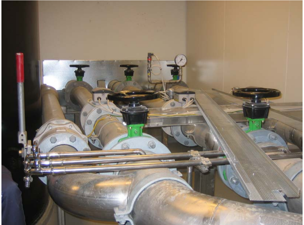
Kuva 5 Tulevan raakaveden putket
