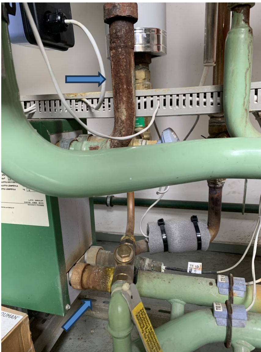
Kuva 11. Korroosiota kaukolämmön alajakokeskuksessa.
