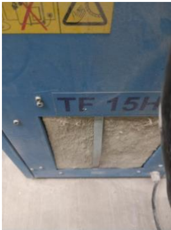
KUVA 18. Lämmityslaitteen suodatin tukossa (YIT työmaat n.d.)
