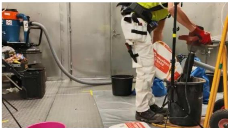
KUVA 10. Laitekohtainen kohdepoisto huuva yhdistettynä imuriin (Työterveyslaitos 2022h)
