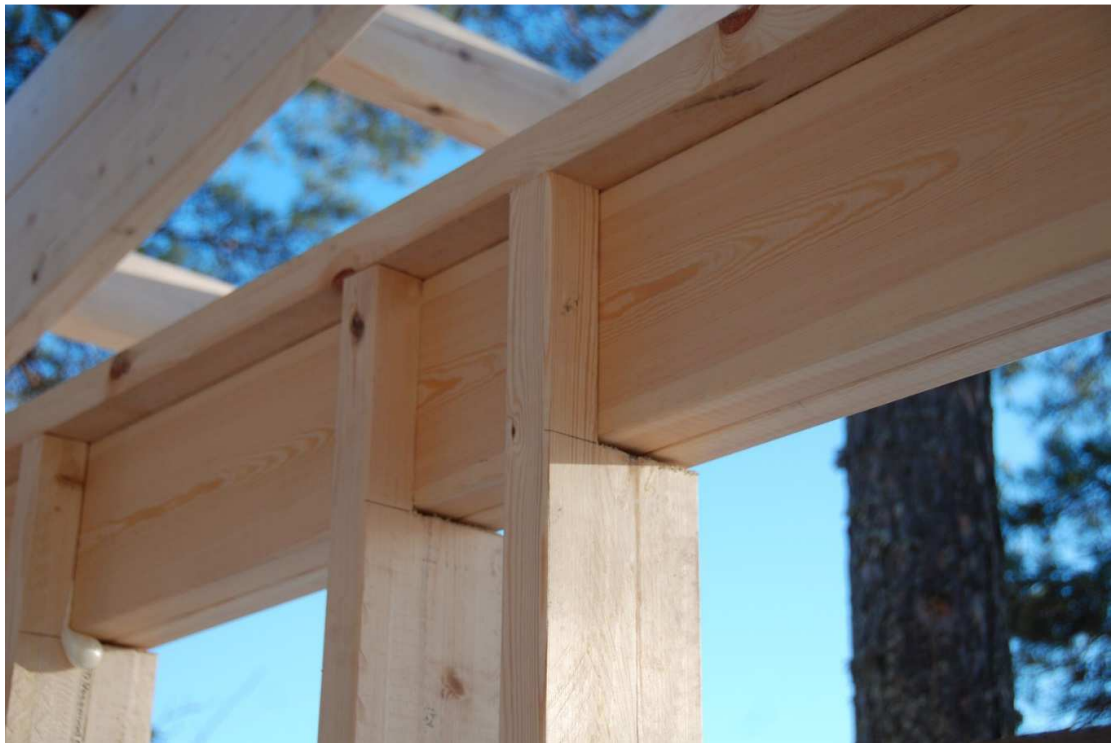
Kuva 8 Kattotuolien kannattajat (asiakkaan ottama kuva)
