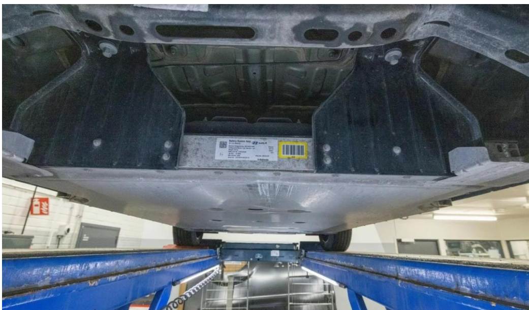
KUVA 10. Kia Niro EV akustovaurio (Kokkonen, Saarinen & Tuppurainen 2024)
