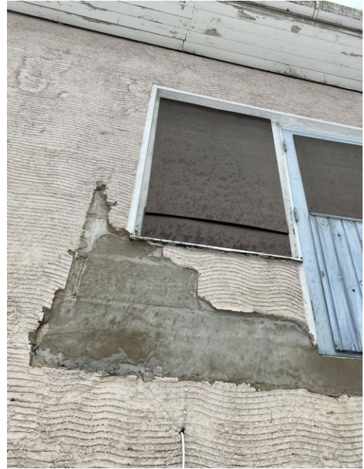
KUVA 44. Länsijulkisivulta poistettu parvekerakenne sekä rappauksen alta paljastuneet kevytbetonihiharkot (Roosa Hiltunen 2024).
