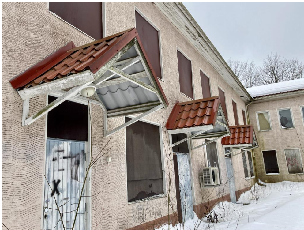
KUVA 41. Rakennuksen pohjoisjulkisivu ja sisäänkäyntien harjakatokset (Roosa Hiltunen 2024). Valtaosa rikotuista ikkunoista on suljettu vanerilevyillä.
