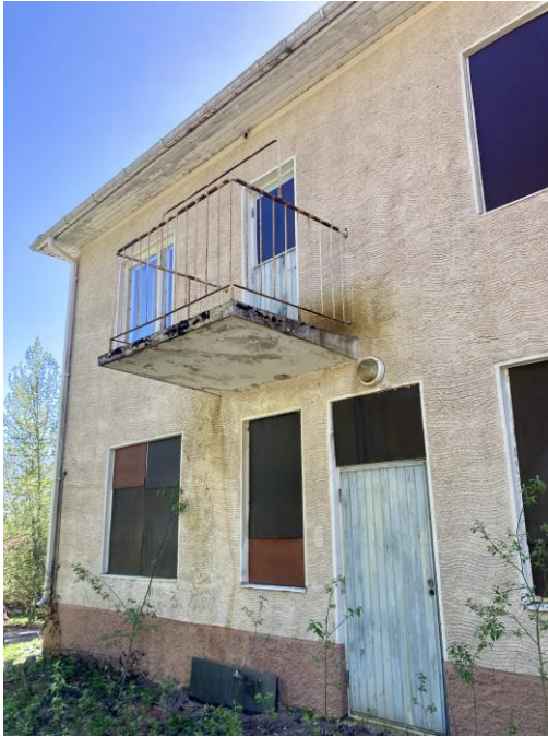
KUVA 43. Pohjoisjulkisivun huonokuntoinen parveke (Roosa Hiltunen 2024).
