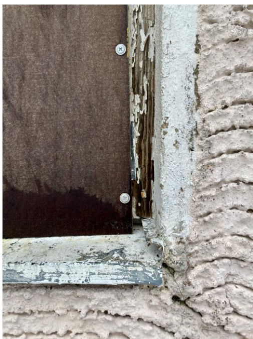
KUVA 36. Alkuperäisen ikkunan nurkkaus (Roosa Hiltunen 2024). Ikkunan ympärillä on valkoinen rapauskehys.
