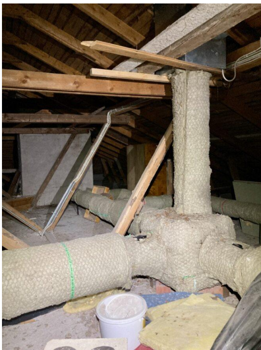
KUVA 63. Ullakolle sijoitettuja viemäreiden tuuletuskanavia (Roosa Hiltunen 2024).
