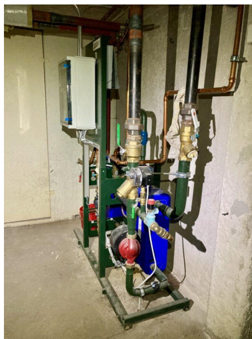
KUVA 50. Kaukolämmön Cetetherm-merkkinen alajakokeskus (Roosa Hiltunen 2024).
