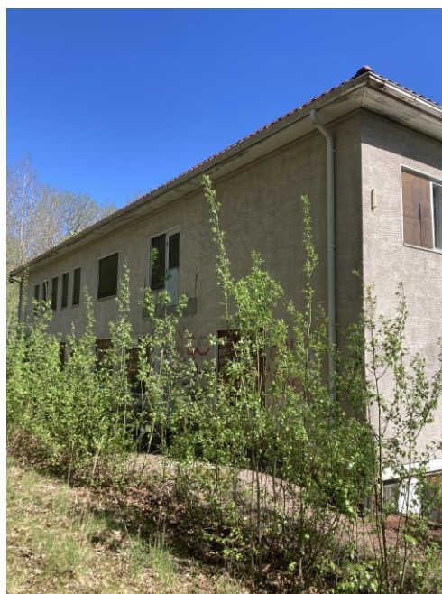
KUVA 75. Kasvillisuutta lähellä rakennusta länsijulkisivulla (Roosa Hiltunen 2024).
