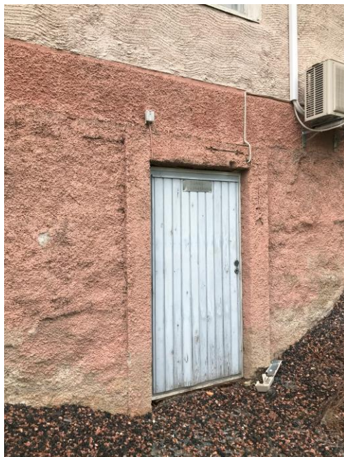
KUVA 33. Alkuperäisrakennuksen kellarin sisäänkäynti itäjulkisivulla (Roosa Hiltunen 2023). Rappauksen väri on vaurioitunut.
