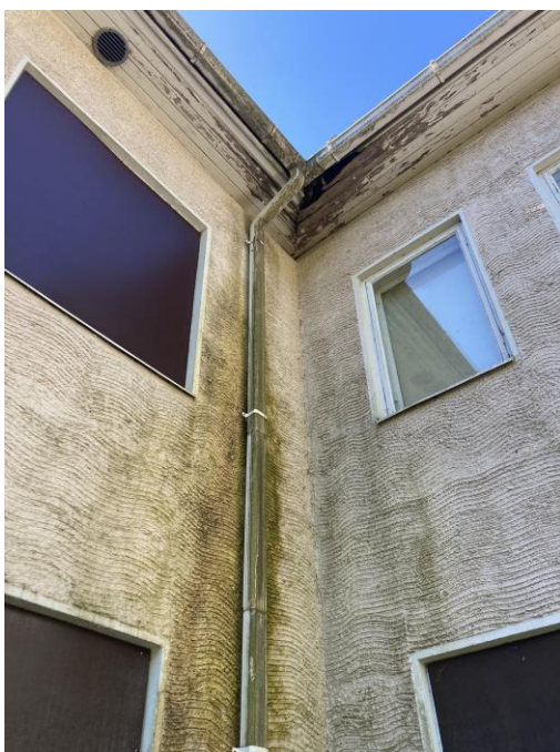
KUVA 31. Pohjoisjulkisivulla ulkopuolisesta kosteusrasituksesta aiheutunut vaurio (Roosa Hiltunen 2024).
