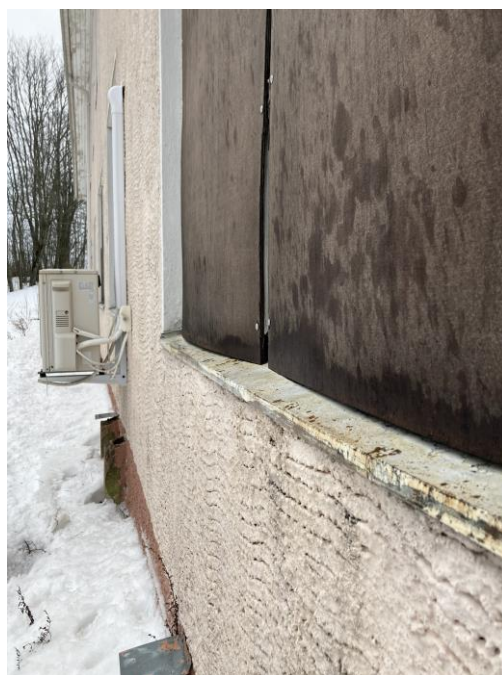
KUVA 37. Vaurioitunut ikkunapellitys (Roosa Hiltunen 2024).
