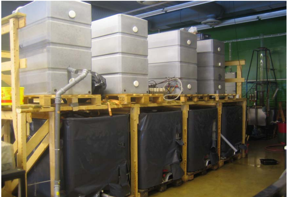
Kuva 1. Kuva laitteistosta. Suodattimet ovat harmaat laatikot, joita pitkin jätevesi suodattuu mustalla muovilla peitettyihin muovisäiliöihin.
