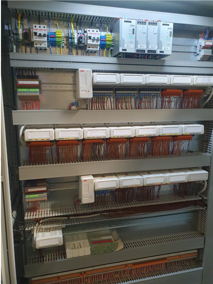
KUVA 4. R703 ristikytkentäkaappi sisältä
