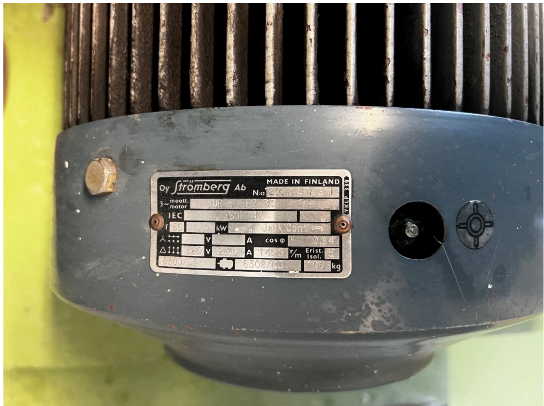
Kuva 6: Kohteessa olevan puhaltimen moottorin kilpitiedot
