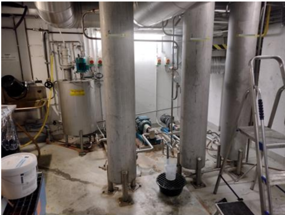
KUVA 1. Välisäiliöt ja sekoitussäiliö (takana) pumppuineen viimeistyskoneen alla.
