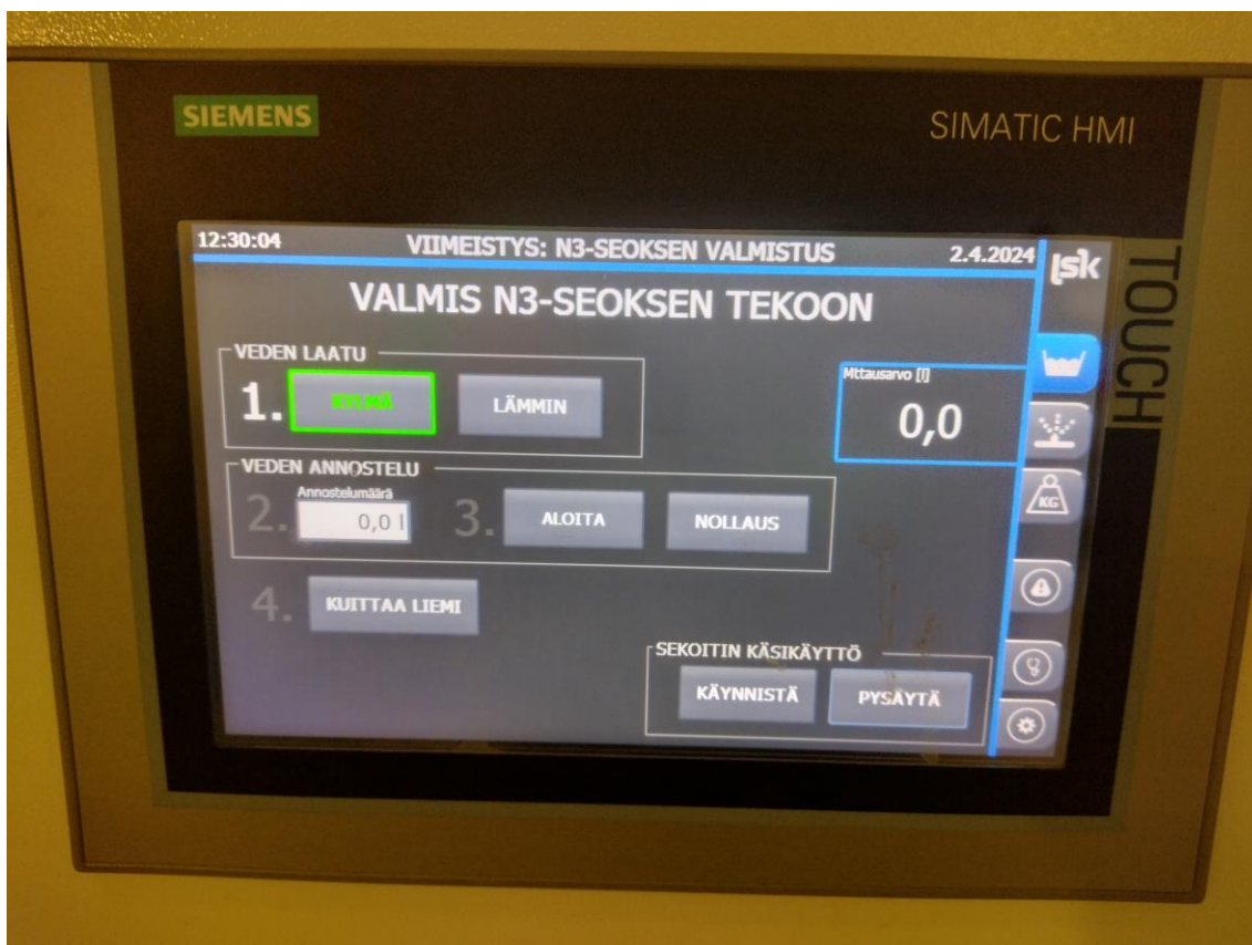
KUVA 3. Veden syötön säätely N3- liuokselle.
