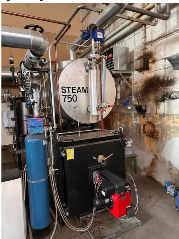
Figur 5. Nuvarande ångpannan i anläggningen.
