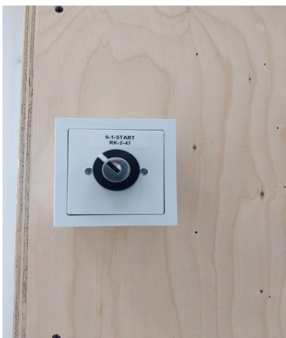
KUVA 2 Asennusseinässä oleva avainkytkin (Kolari 2024)
