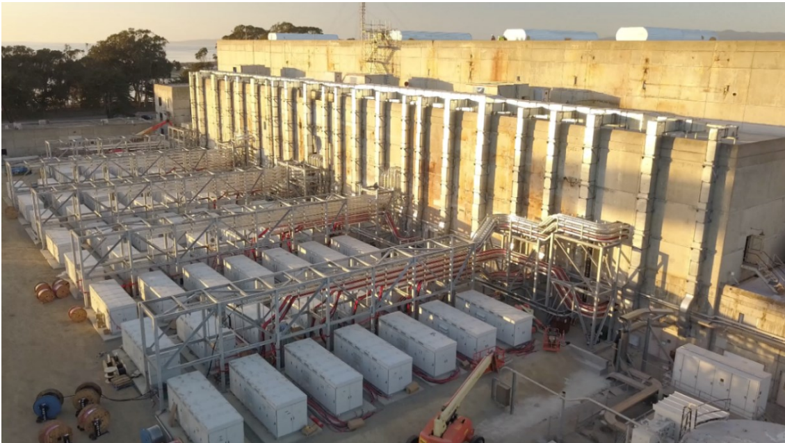
Kuvio 17. Moss Landing Energy Storage Facility ulkopuolelta (Vistra Corp 2021)
