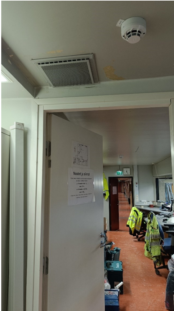
Kuva 14. Työhuoneen 2 ilmanvaihto seinän takana.
