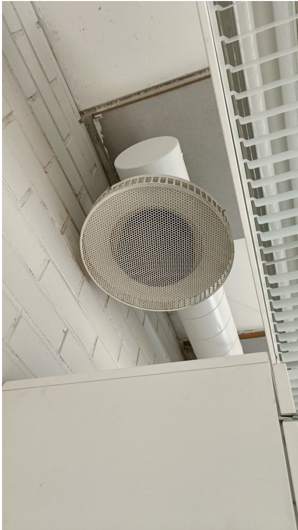
Kuva 10. Tuloilman päätelaite luokan takaosassa.
