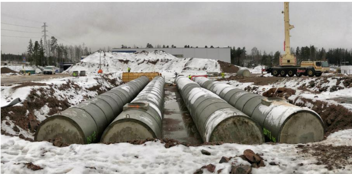
Kuva 3. DSV Logistics Center sprinklerisäiliö (kuva: RB Infra b).
