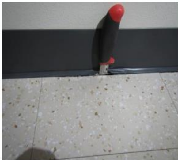
Kuva 4. Selkeä rako alapohjan ja ulkoseinän välissä pienryhmätilassa (Kiwa Inspecta).
