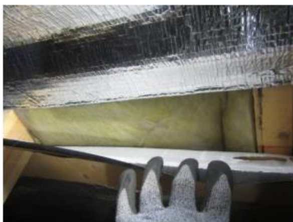
Kuva 5. Yläpohjan huonosti saumattuja höyrynsulkuja (Kiwa Inspecta).
