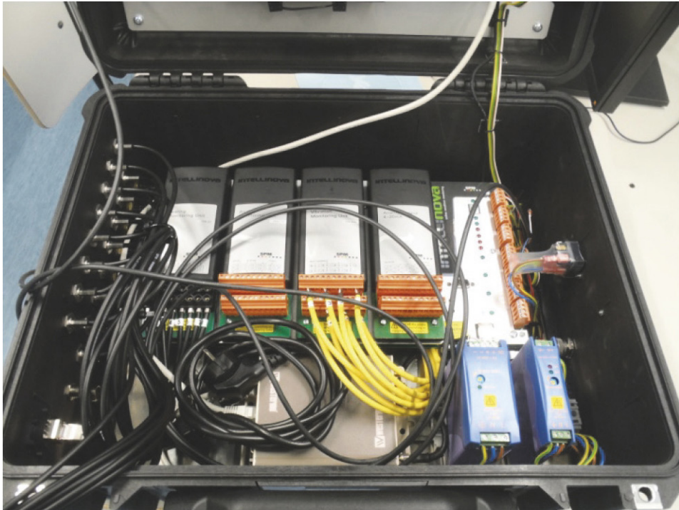
Kuva 31. Tuotantolaitteiston toimintasuureiden mittauslaitteisto, Intellinova.
