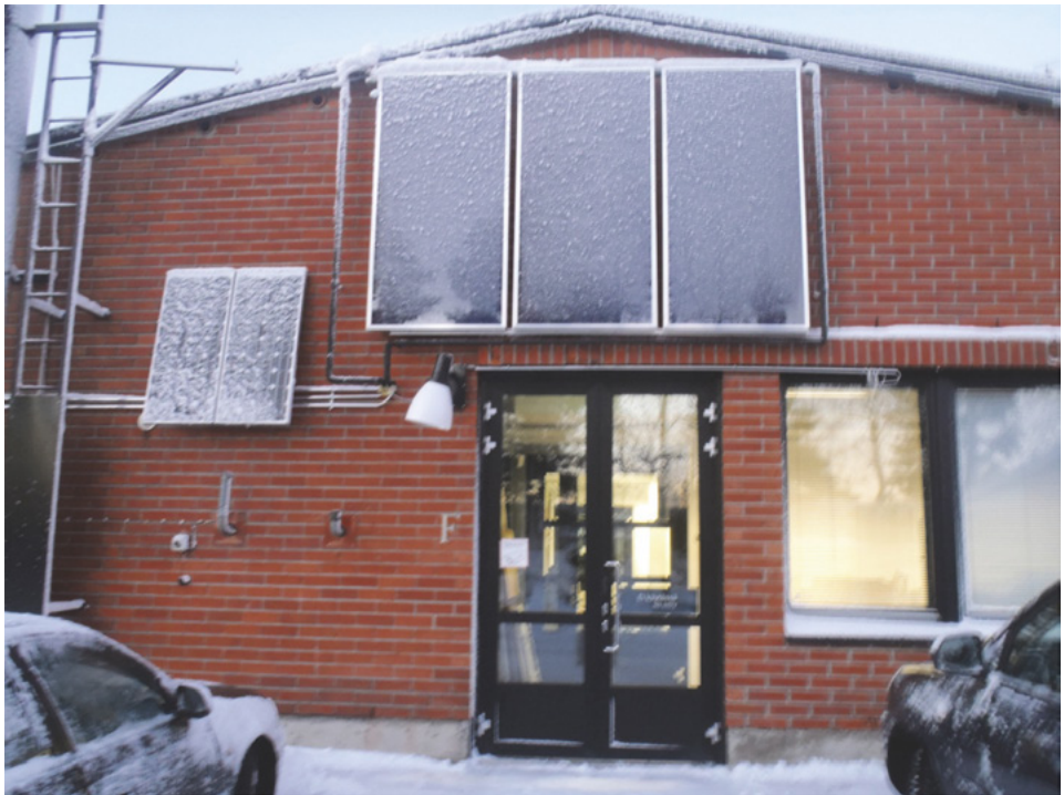
Kuva 15. Tyhjökeräin tekniikan yksikön päätyseinällä oven yläpuolella.
