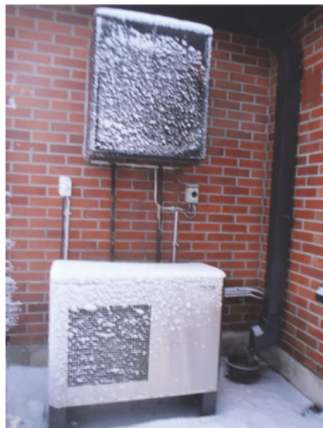
Kuva 17. b) ulkoseinälle sijoitettu ilma-vesilämpöpumppu.
