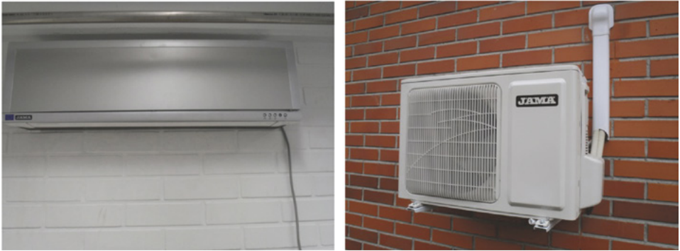
Kuva 18. Energiatekniikan laboratorion ilmalämpöpumpun sisä- ja ulkoyksikkö.
