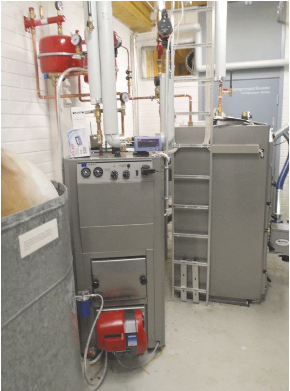
Kuva 13. JÄSPI Ecolux 17 kattila energiatekniikan laboratorion viereisessä kattilahuoneessa, vasemmalla öljysäiliö ja oikealla biotriplex kattila.
