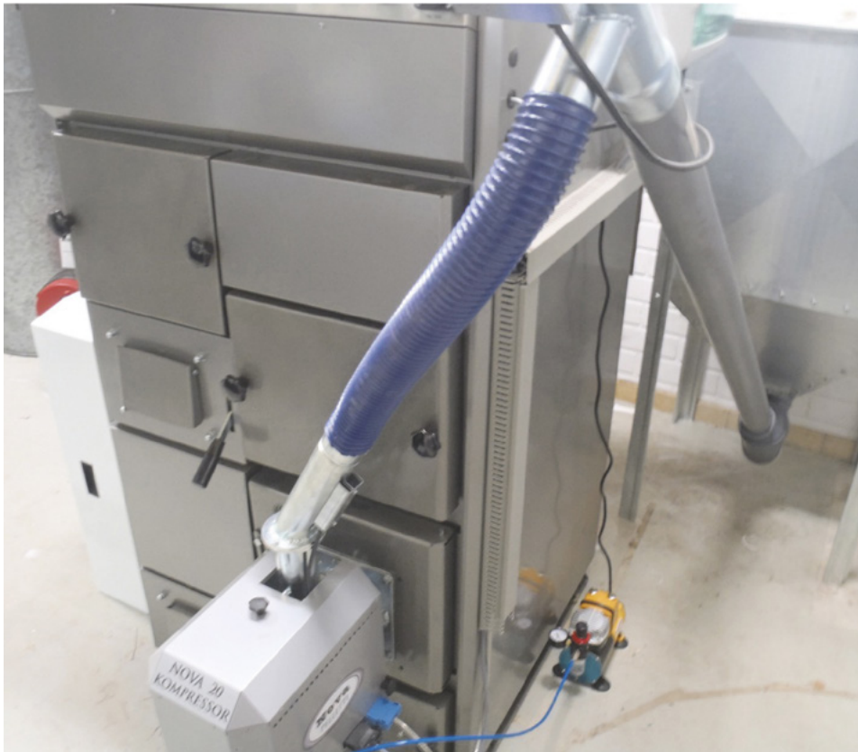
Kuva 12. Biotriplex-kattila energiatekniikan laboratorion viereisessä kattilahuoneessa.
