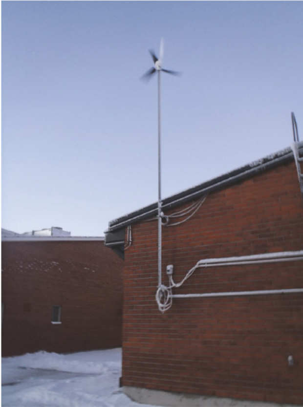
Kuva 24. Tuulivoimala Whisper ulkona talviolosuhteissa, seinän takana on kattilahuone.
