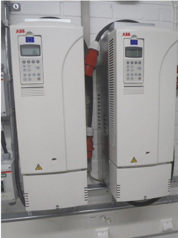
Kuva 26. Verkkoon jarruttaviin taajuusmuuttajiin perustuva sähköntuotannon oppimis- ja tutkimusympäristö sähkövoimatekniikan laboratorion testitilassa.
