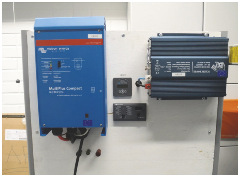
Kuva 28. Kaksi invertteriä (12 VDC / 230 VAC) sijoitettuna siirrettävään asennustelineeseen energiatekniikan laboratoriossa.
