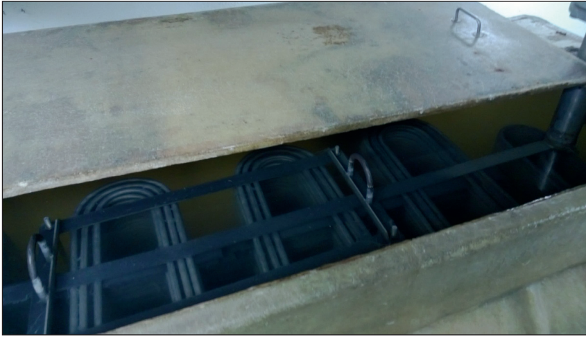
Kuva 5. Uimahallin suihkuveden lämmöntalteenottokennosto.
