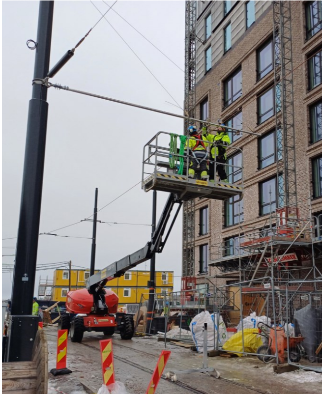
Kuva 3. Ajojohtimen trimmausta yhteiskäyttöpylvääseen kiinnitettyssä tukiorressa trimmauslaserkelkan avulla. Taustalla nähtävissä raiteen mutkassa käytettäviä sivuunvetoköysiä.
