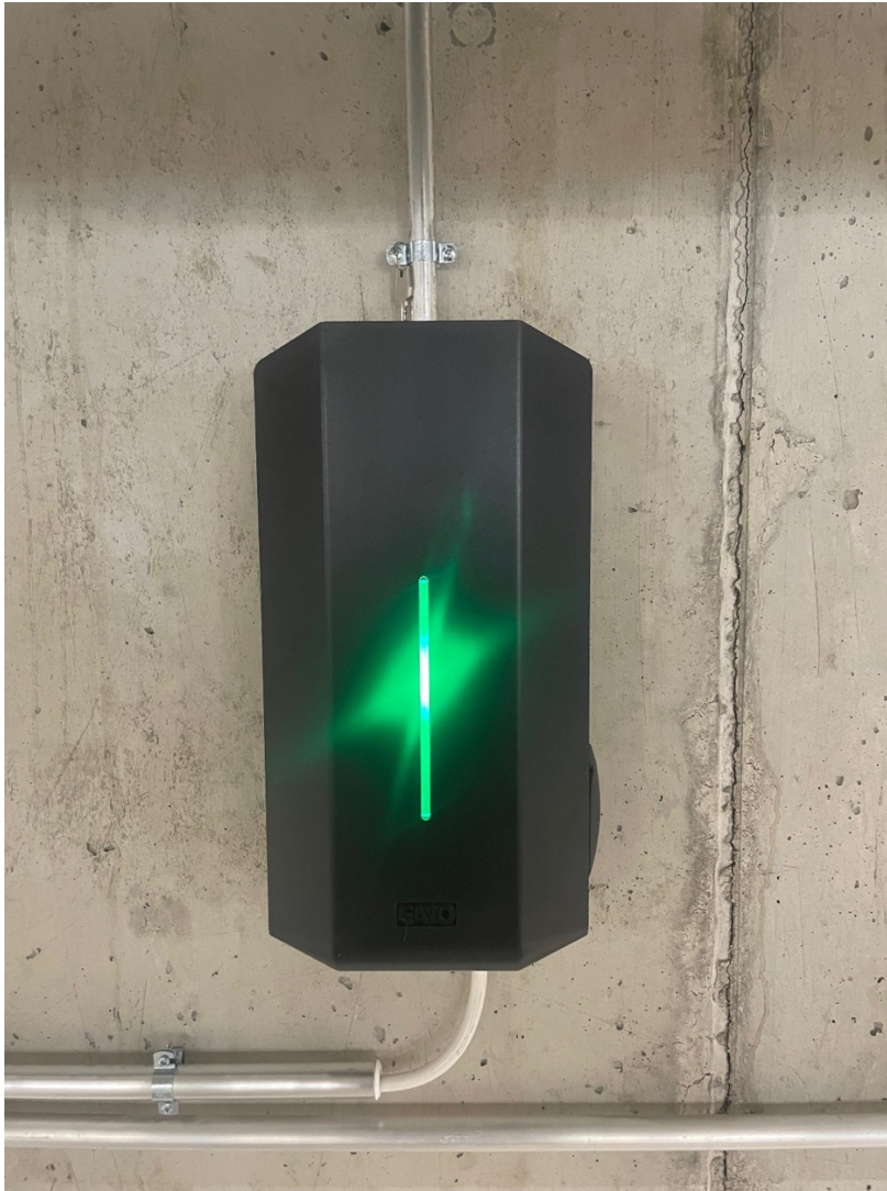
Kuva 6. GARO GLBDC -latausasema
