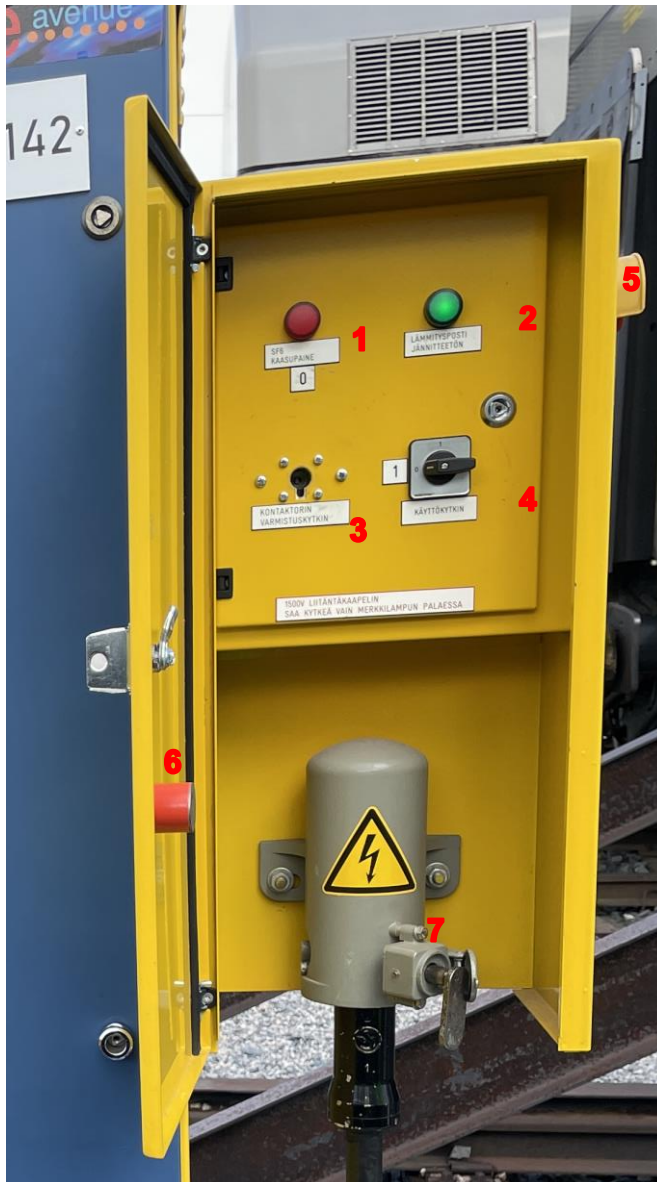
Kuva 9. Vaununlämmityspostin käyttäjille tarpeelliset rakenneosat. 1 vikamerkkivalo, 2 1500 V- merkkivalo, 3 1500 V varmistuskytkin käyttöavaimelle, 4 käyttökytkin syötön päälle ja pois kytkentään, 5 hätä-seis painike, 6 pidike käyttöavaimelle, 7 sokkorasia kaapelille.
