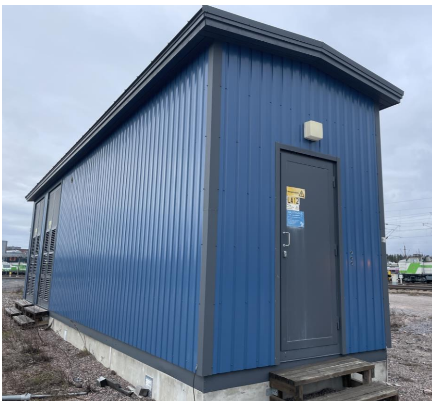
KUVA 4. Kahden muuntajan (A ja B) vaununlämmitysasema Ilmalassa
