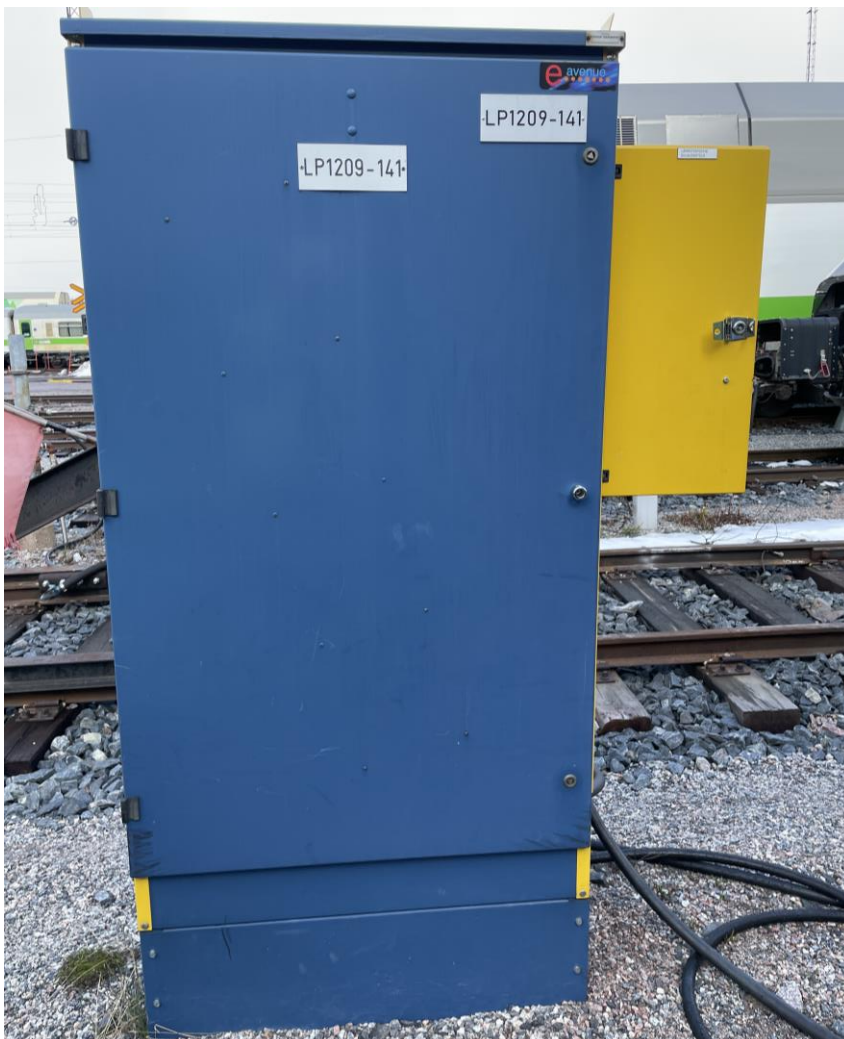
KUVA 8. 1500 V vaununlämmitysposti Ilmalan liikennepaikalla
