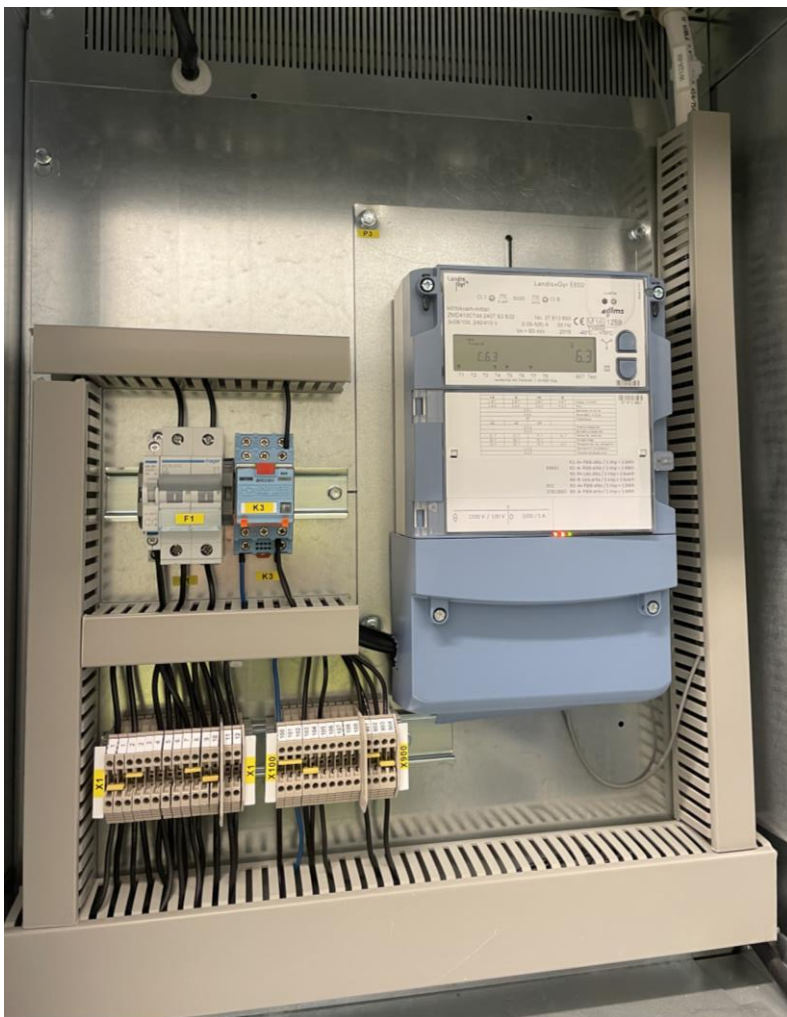
KUVA 13. Kokonaispätötehoa mittaava energiamittari asennettuna vaununlämmitysasemalla Ilmalassa.
