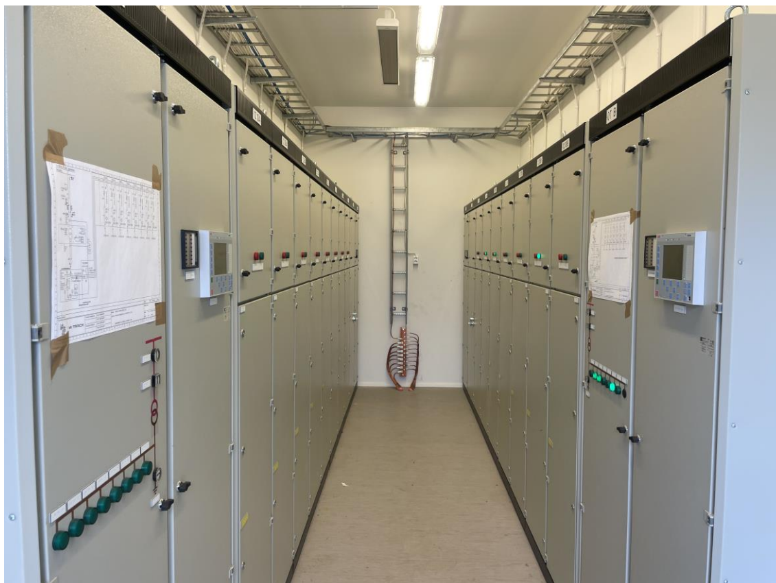
KUVA 7. Ilmalan liikennepaikalla oleva vaununlämmitysasema, jossa on kahden muuntajan pääkeskukset mallia UTU Group N400.
