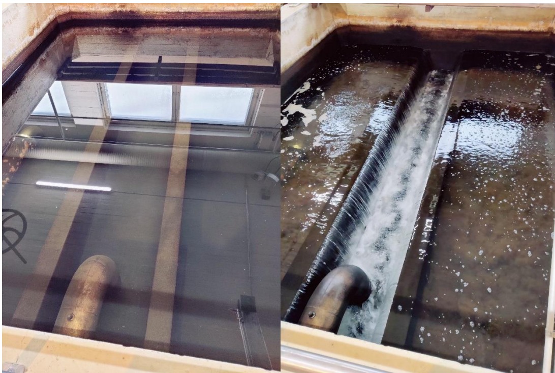
Kuva 2. Hiekkasuodatin ja sen elvytys.
