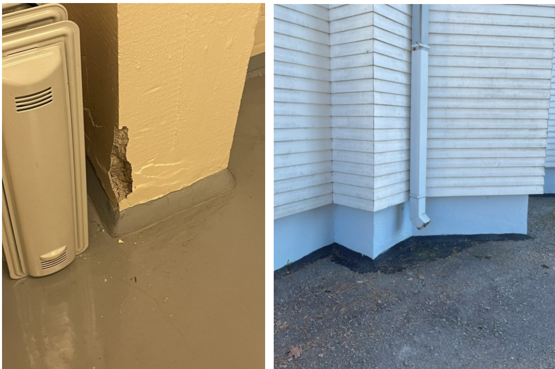
KUVA 85. Kellarin vanhan osan seinien pinnasta murentunutta betonia.
