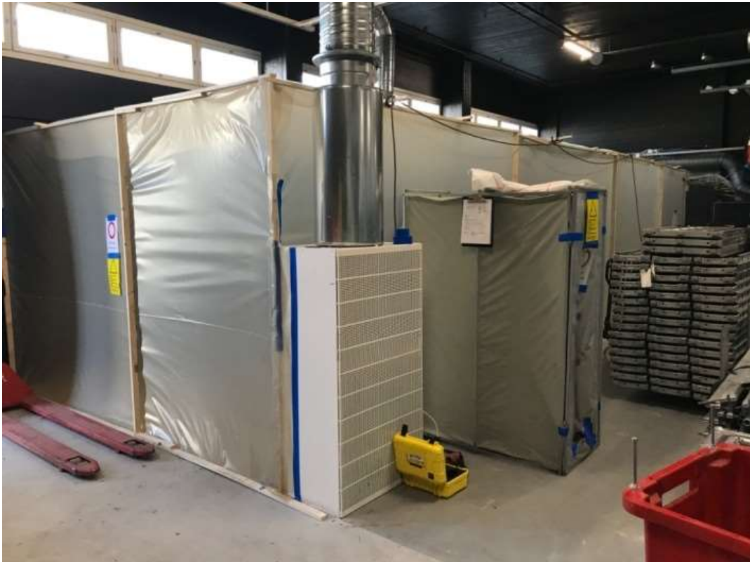
Kuvio 10. Osasto, sulkutunneli ja alipaineistus (Suomen Asbestiteknikka Oy 2024.)
