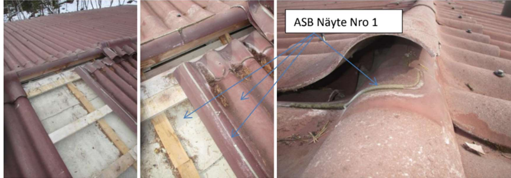
Kuvio 14. Yläpohjarakenteen asbestit (HUMICONTROL OY 2021.)
