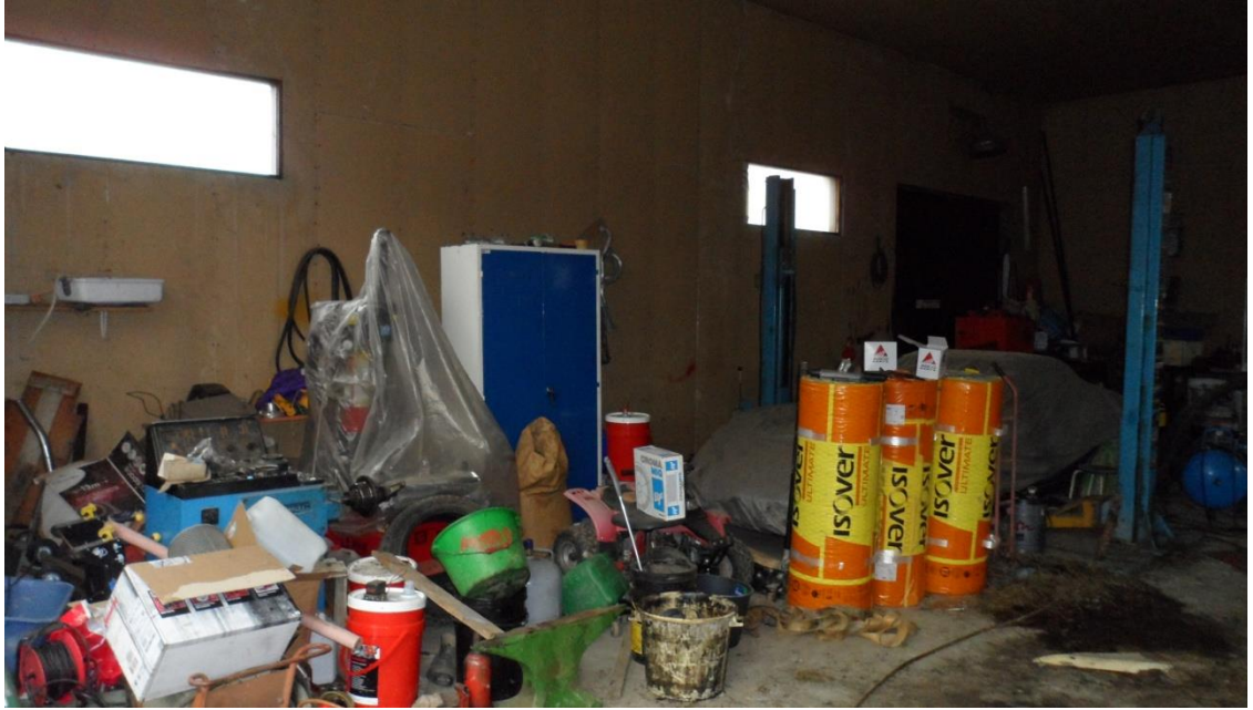
Kuva 21. Palavat nesteet ja kaasut ovat sekaisin olevan tavaran kanssa samassa tilassa. Hallin järjestely/siivous tehtävä pikimmiten.
