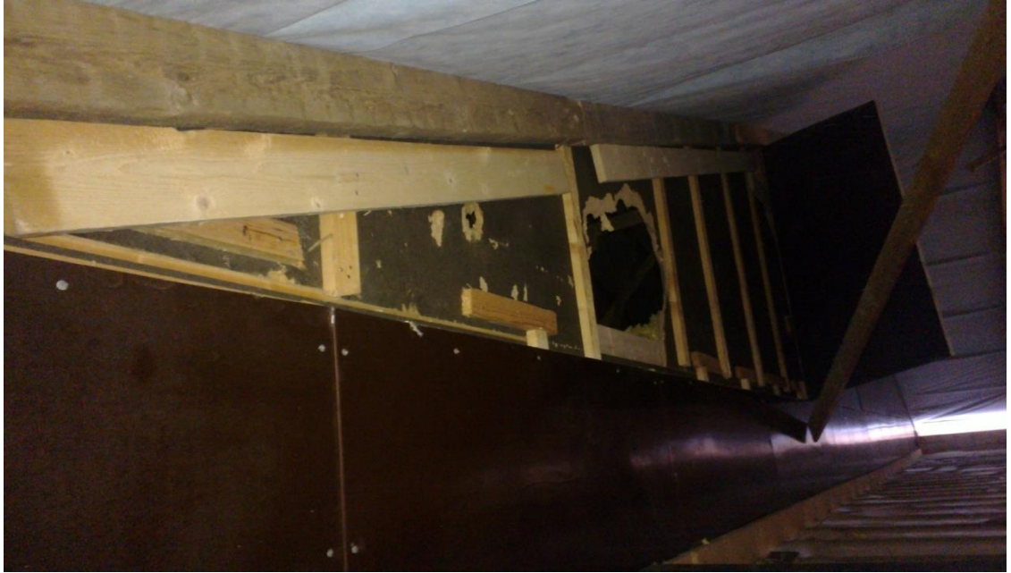
Kuva 13. Puutteellinen yläpohjan osastointi, korjattava.
