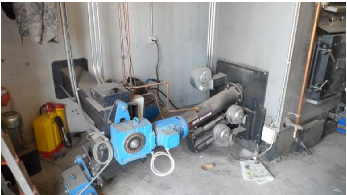
Kuva 3. Kiinteänpolttoaineen järjestelmä. Kuvassa on kaksi toisistaan riippumatonta takapalon estävää toimintaa. Ensimmäisenä lokerosyötin, joka pysähtyy takapalon ilmaantuessa ja toisena sammutusvesijärjestelmä, joka päästää vettä polttoaineen syöttöputkeen, kun lämpötila putkessa nousee yli säädetyn rajan.
