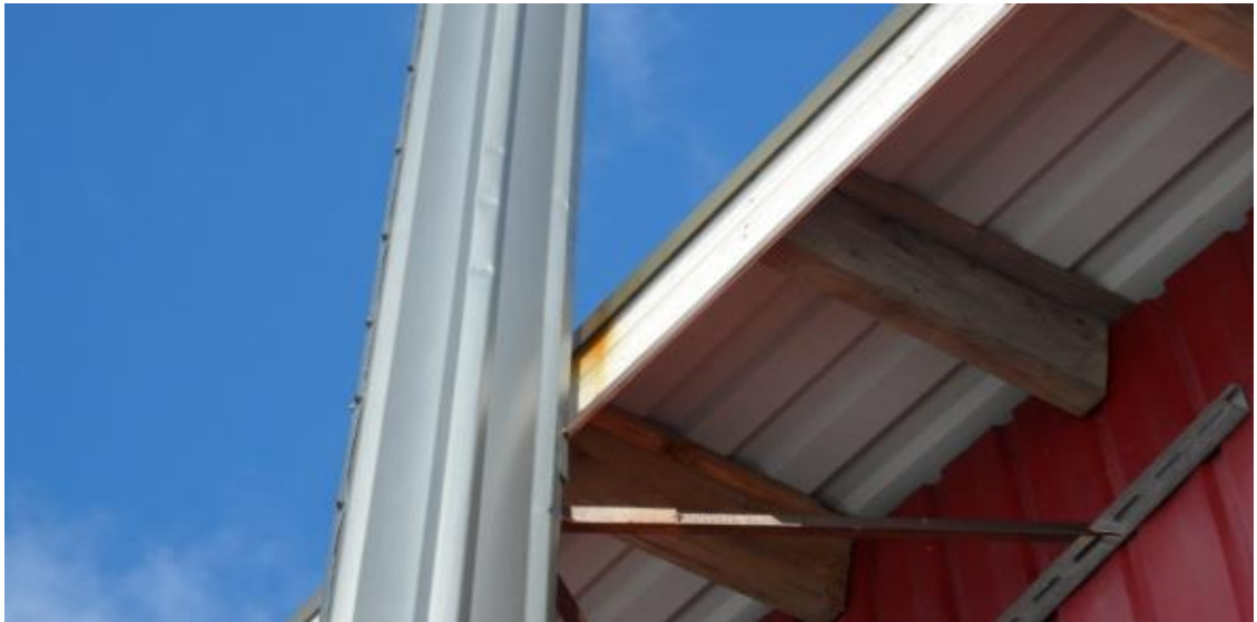
Kuva 7. Savuhormin suojaetäisyys ei täyty, tummuneet räystäslaudat.
