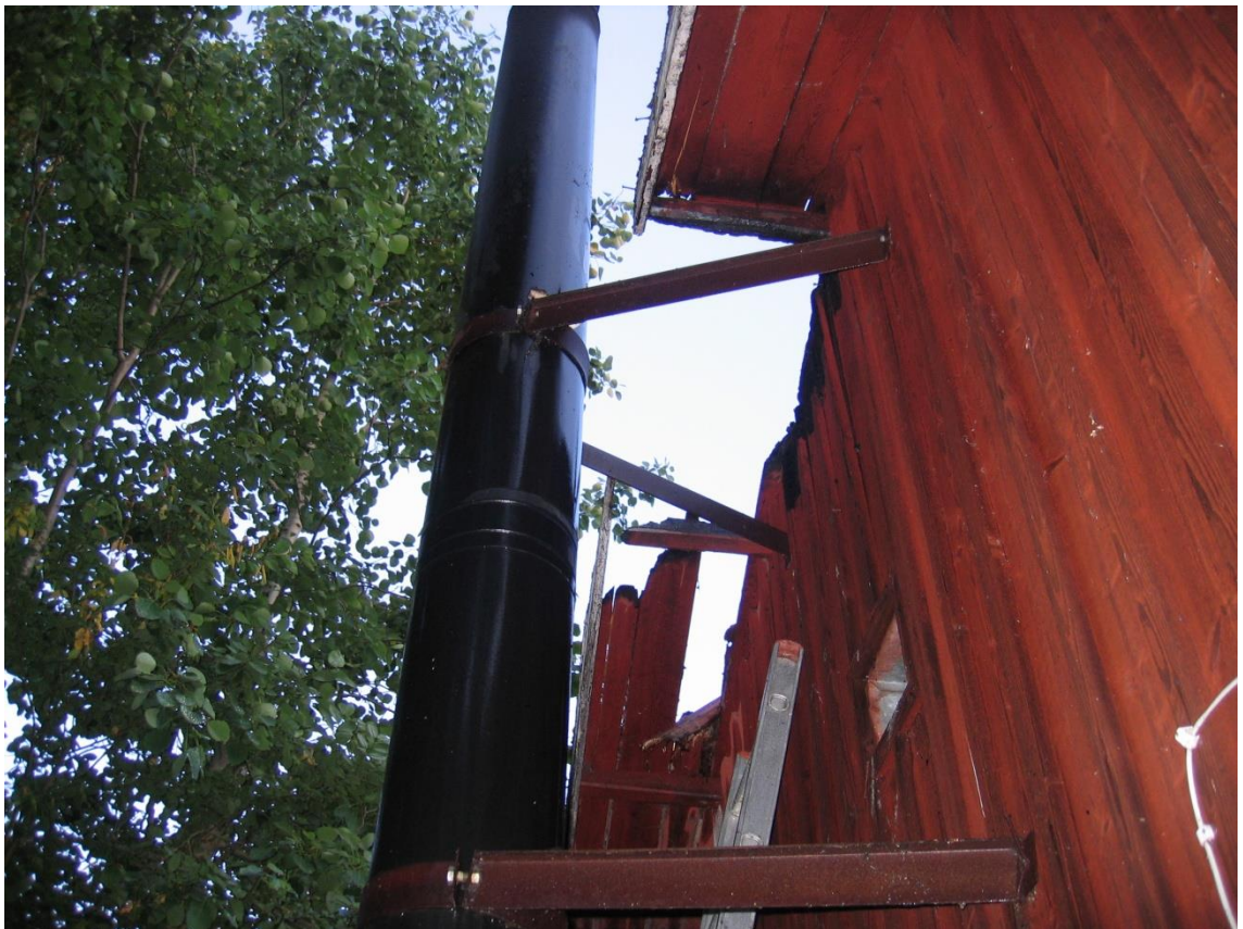
Kuva 8. Liian pieni savuhormin suojaetäisyys on sytyttänyt räystäslaudat ja rakennuksen yläpohjan palamaan.
