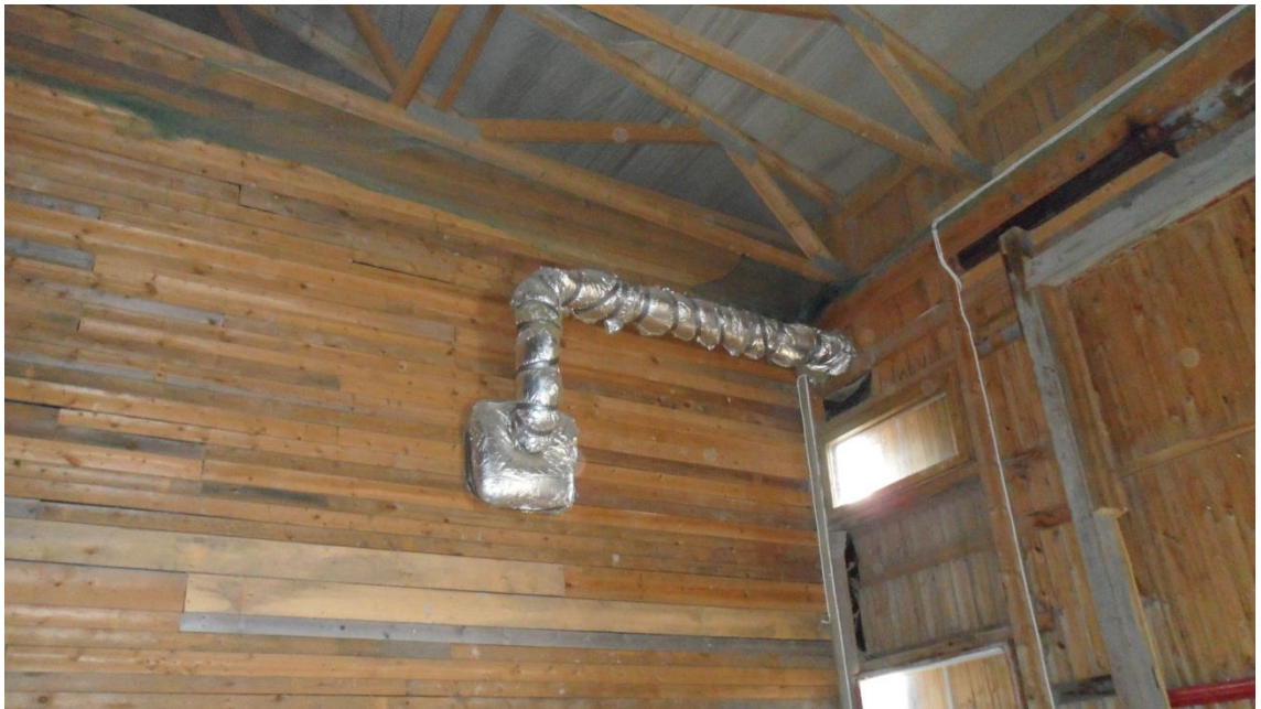
Kuva 14. IV- putkien osastointi toisen palo-osaston matkalta.
