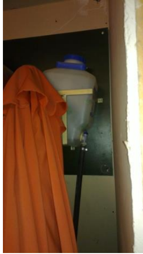
Kuva 4. Tyhjä vesisäiliö, korjattava.
