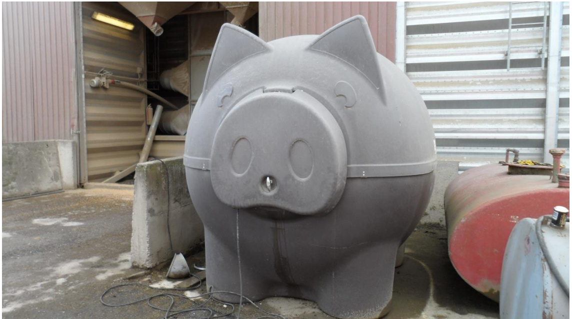
Kuva 20. Öljysäiliö on asianmukaisessa valuma-altaassa ja lukittuna. Merkinnät puuttuvat.
