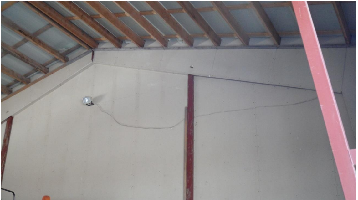
Kuva 9. Seinällä pysyväisluontoinen sähkökytkentä, muutettava/poistettava.
