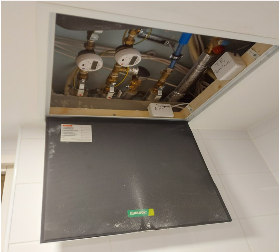
Kuva 4. Asuntokohtaiset vesimittarit huoltoluukun sisällä.
