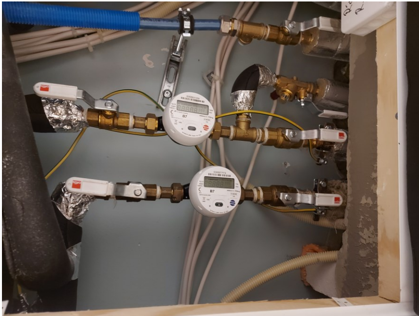
Kuva 1. Etäluettavat vesimittarit asennettuna sulkuventtiilien väliin.
