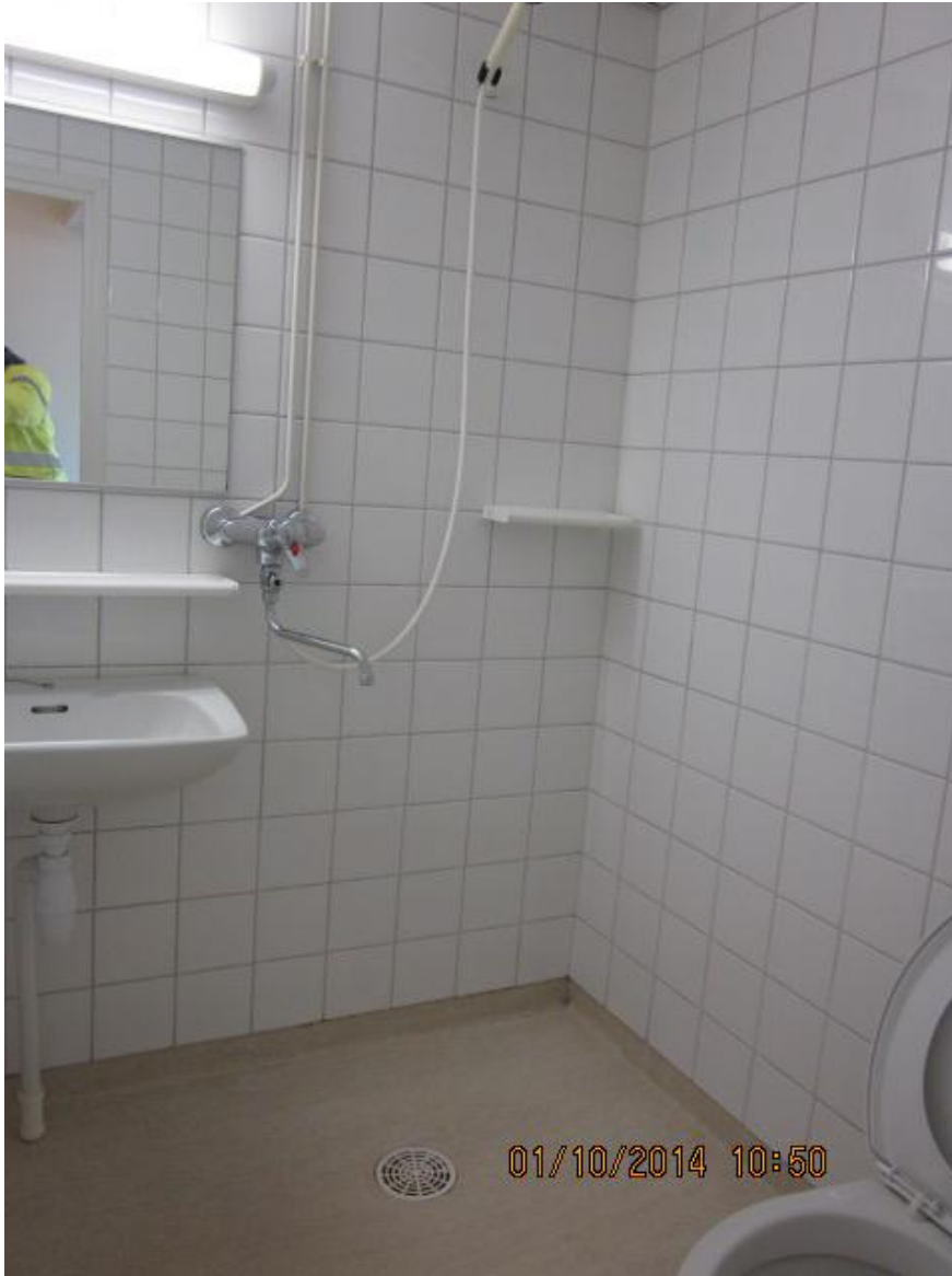
Kuva 2. Asunto 4 A 28 kunnostustyön alkaessa. Kylpyhuoneen seinälaatoitukselle ja lattiamatolle suoritetaan asbestipurku. Seinät vesieristetään ja laatoitetaan uudestaan, myös matto uusitaan.
