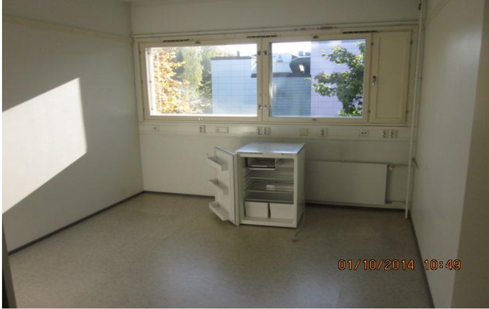
Kuva 1. Asunto 4 A 28 kunnossapitotyön alkaessa. Seinissä on hankaumia ja muita asumisen aiheuttamia jälkiä. Lattialla oleva vanha matto on parhaan päivän näköinen ja on vaihdon tarpeessa.
