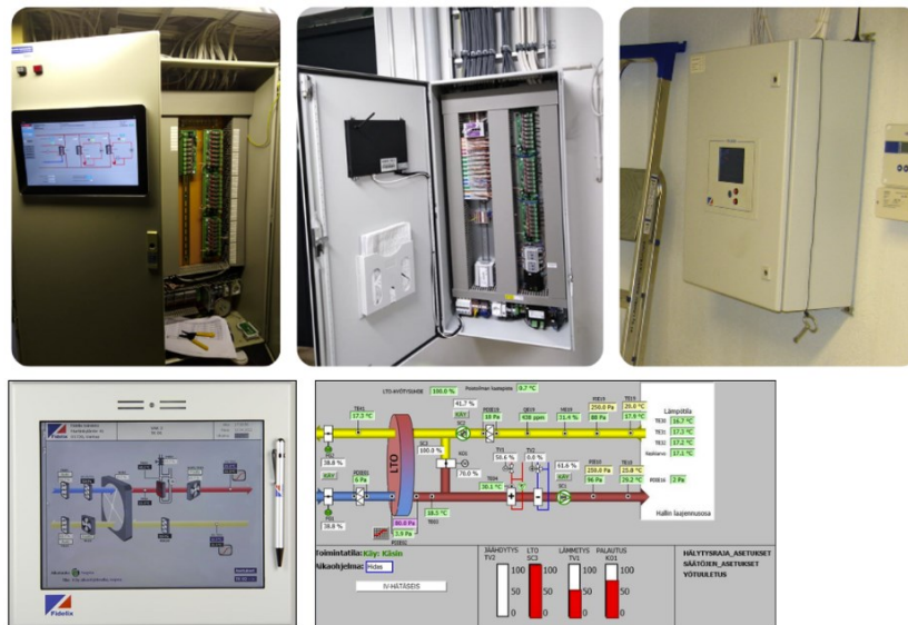
Kuva 29. Fidelixin laitteistoa ja valvomratkaisuja.
