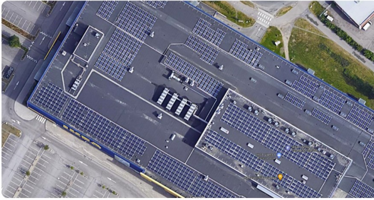
Kuva 81. Nestelauhduttimia aurinkopaneelien seassa Vantaalla sijaitsevan rakennuksen katolla.
