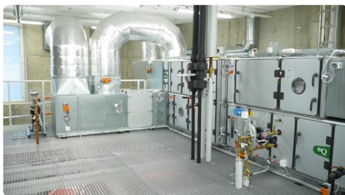
Kuva 59. Ilmanvaihtokonehuone, jossa on näkyvissä ilmanvaihtokoneen lämmitys- ja jäähdytyspatterit, toimilaitteita, sekä antureita.
