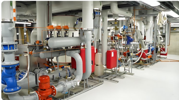
Kuva 3. Lämmönjakohuone, josta jaetaan lämpöä eri puolille rakennusta lämmönsiirtimien avulla.
