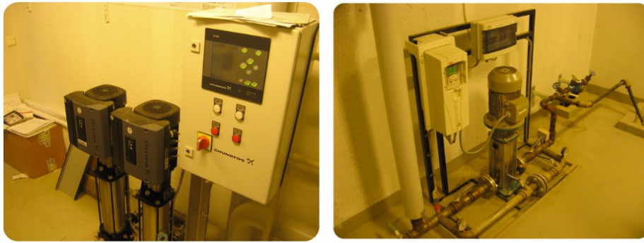
Kuva 21. Grundfos CU 351 -ohjausyksikkö pumppuineen sekä ABB:n taajuusmuuttajalla säädettävä sähköpumppu.
