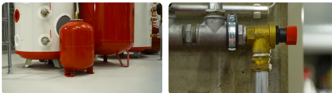
Kuva 55. Vasemmalla punainen paisuntasäiliö ja oikealla putkistoon asennettu varoventtiili.
