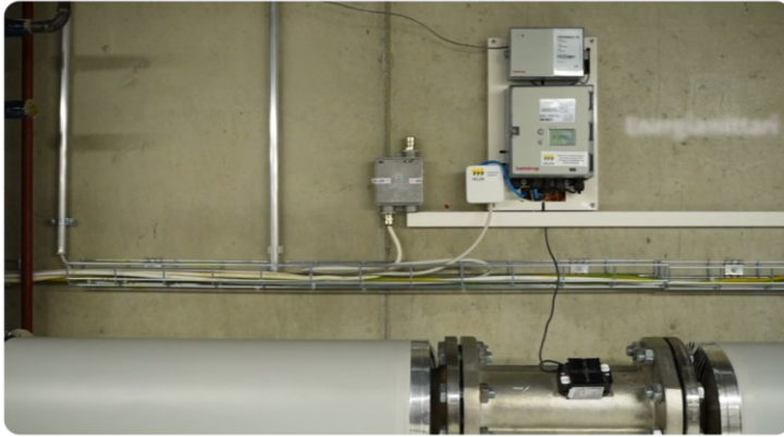
Kuva 4. Helenin lämpöenergian mittaus, jolla seurataan rakennuksen kulutusta.
