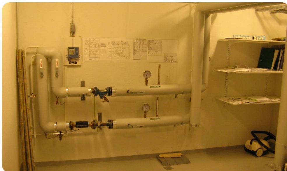
Kuva 33. Lämmönjakuhuoneen seinällä oleva säätökaavio.
