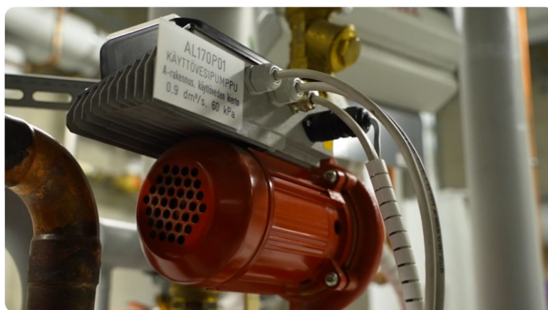
Kuva 56. Kiertovesipumpun toiminta-alue tarkennettuna, eli käyttövesipumppu.
