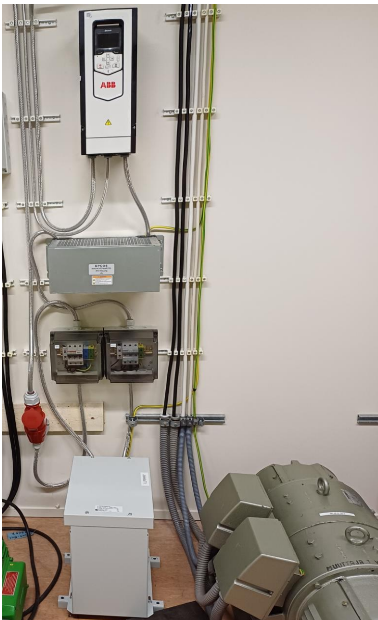
Kuva 12. Jokelan laittilan uudet taajuusmuuttaja-asennukset.
