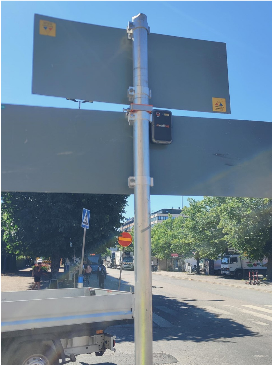
Kuva 5. Intellitag asennettuna liikennemerkkipylvääseen
