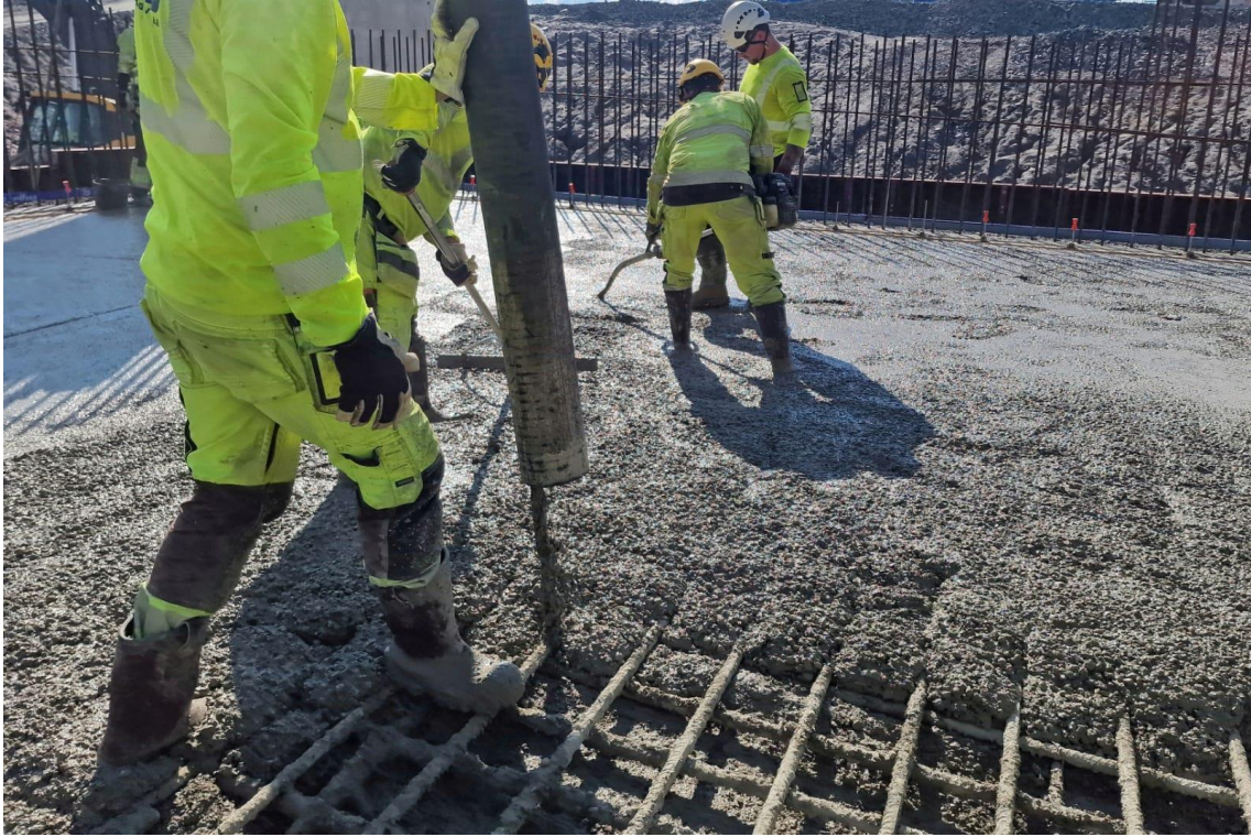
KUVA 10. Harvan raudoituksen aiheuttama kompastumis- tai horjahtamisriski on mahdollinen valun aikana.
