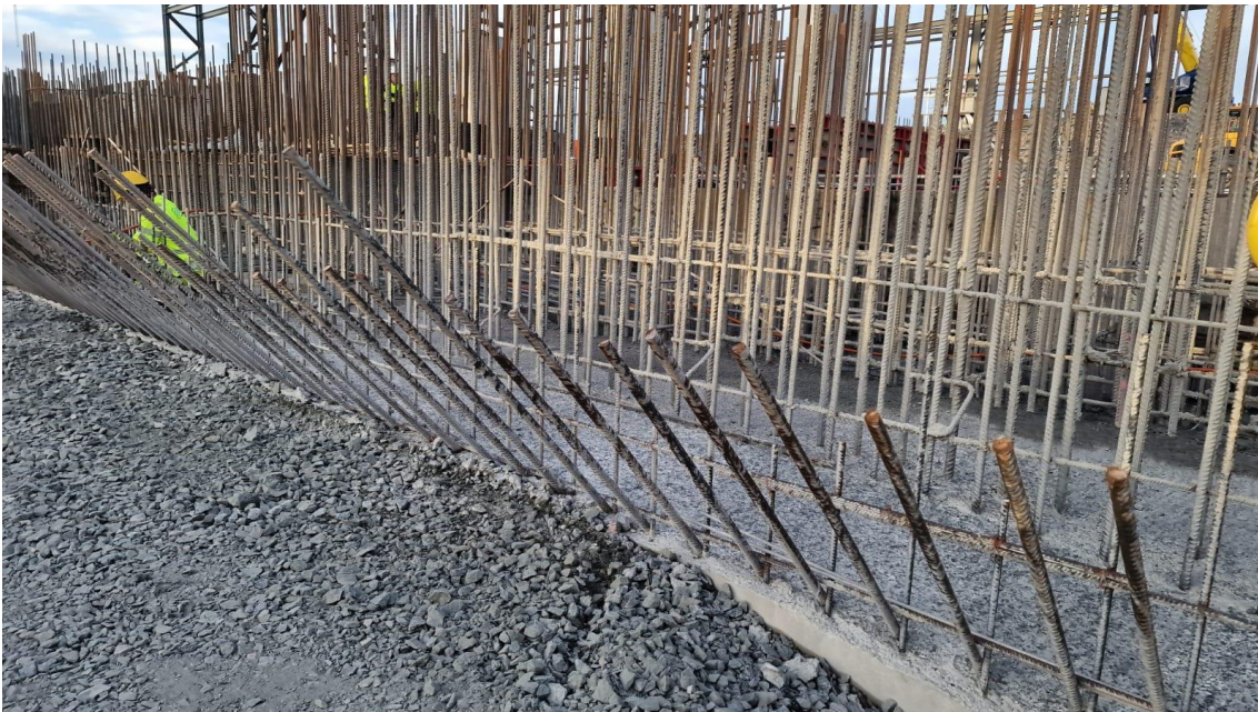
KUVA 5. Erään kohteen suojaamattomat harjateräkset aiheuttavat tarpeettoman työturvallisuushan työmailla.
