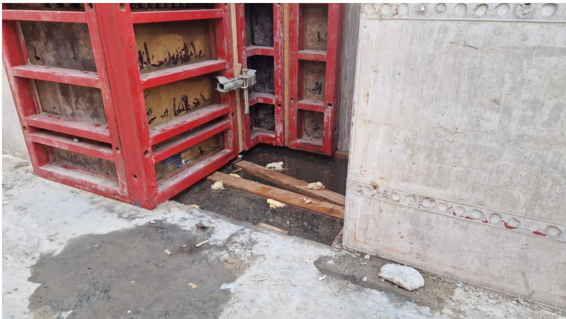
KUVA 14. Muotin purun jäljiltä syntynyt suojaamaton, sadevedestä täyttynyt kuilu aiheuttaa suuren työturvallisuusriskin.
