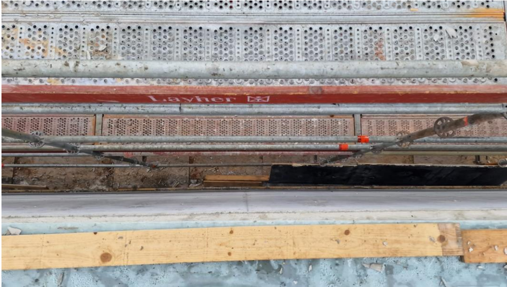
KUVA 13. Muotin purun jälkeen syntynyt mahdollinen putoamisvaara.
