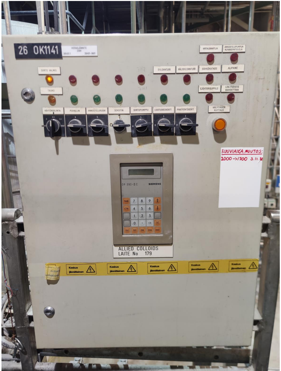
KUVA 3. Retentioaineliettolaitteisto ohjauskeskus 26OK1141
