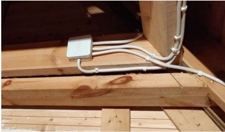
KUVA 3. Perussuojaus toteutettu asianmukaisella koteloinnilla.
