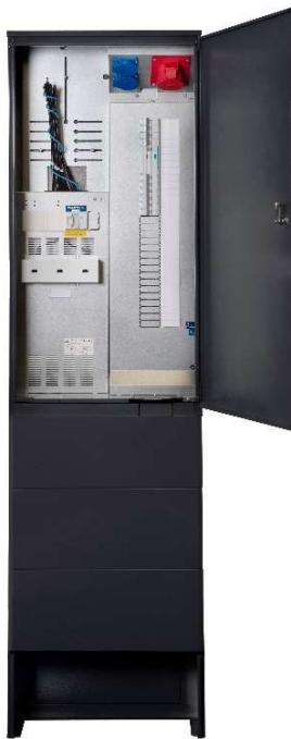
KUVA 15. Mittauskeskus FE COLLIE 3806P63 2T+PR JAL x 63A (UTU Group s.a).
