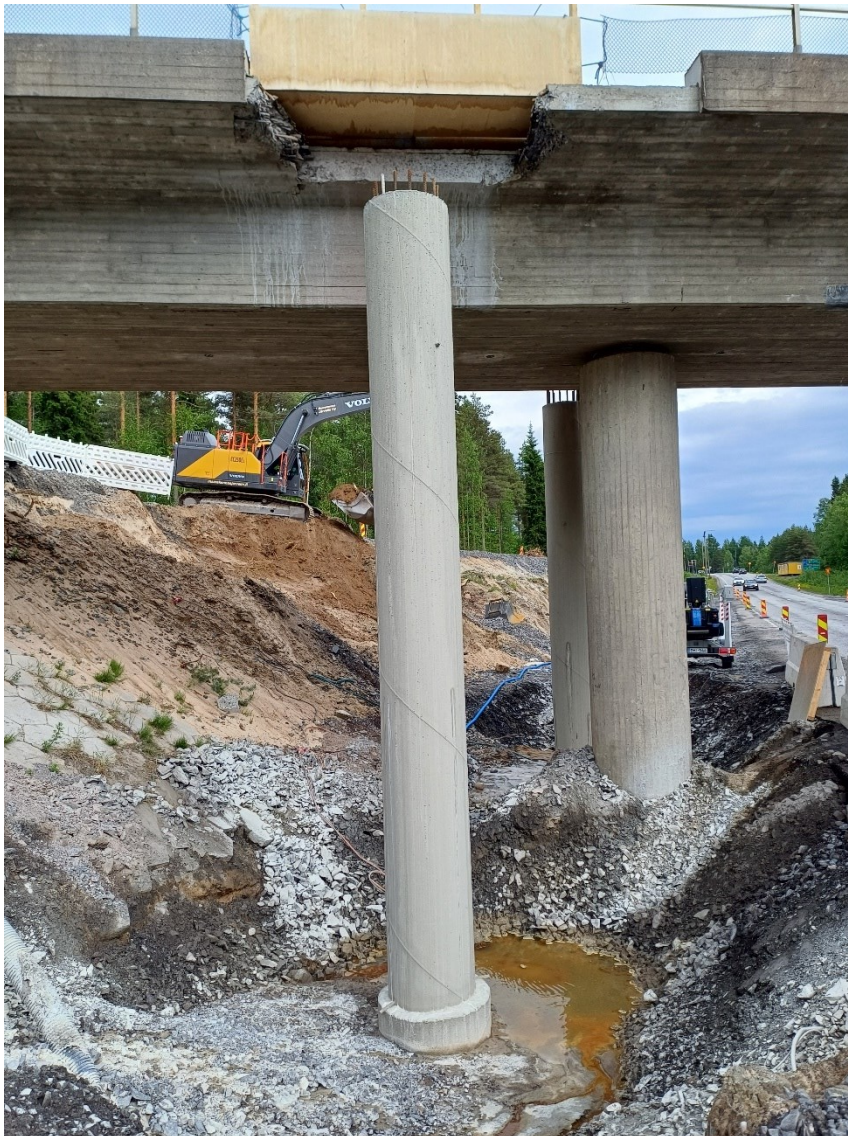
KUVA 3. Pora- ja lyöntipaalu välituella
