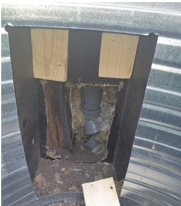
Kuva 3. Viemärin tuuletusputken liitoskohta paljastui irralliseksi (Organisaation sisäiset asiakirjat 2023.)
