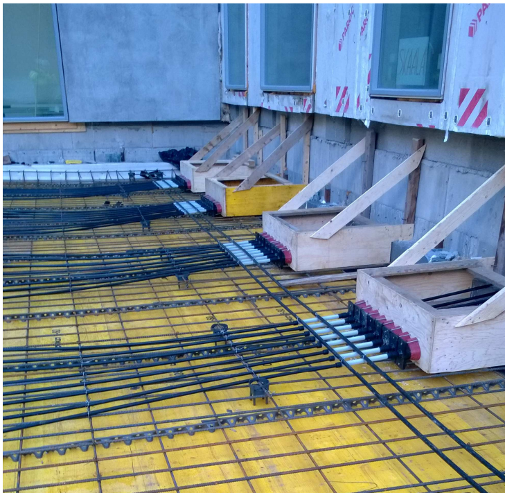
Kuva 20. Laatan jännitysvarauslaatikoita siinä vaiheessa, kun kentän punokset on asennettu paikalleen. Laatikot on ripustettu roikkumaan seinästä, sillä niiden alle valetaan 80 mm paksu kerros betonia holvin valun yhteydessä. Tämä parantaa kannen vedenpitävyyttä.
