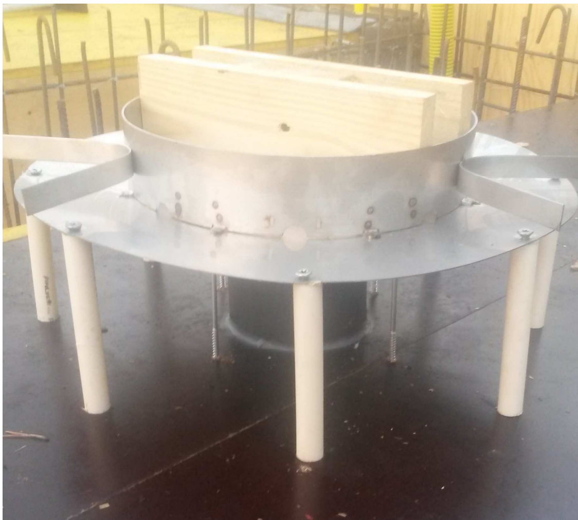
Kuva 6. Yksi mahdollinen tapa asentaa kaivo paikalleen. Tässä on kyseessä ritiläkaivo, joka tulee toimimaan ylemmän kerroksen lattiakaivona. Kaivon laipan alle on porattu viisi 180 mm pitkä ruuvia, joiden päällä kaivo lepää. Lisäksi laipan reunoilta on asennettu sähköputket, joiden tehtävänä on kalliistaa laippaa niin, että se johdattaa mahdollisen kaivon vierelle pääsevän veden kaivon sisälle. Lopuksi kaivo on vielä kiinnitetty kiripuulla kiinni, ettei se pääse nousemaan valun aikana ylös.
