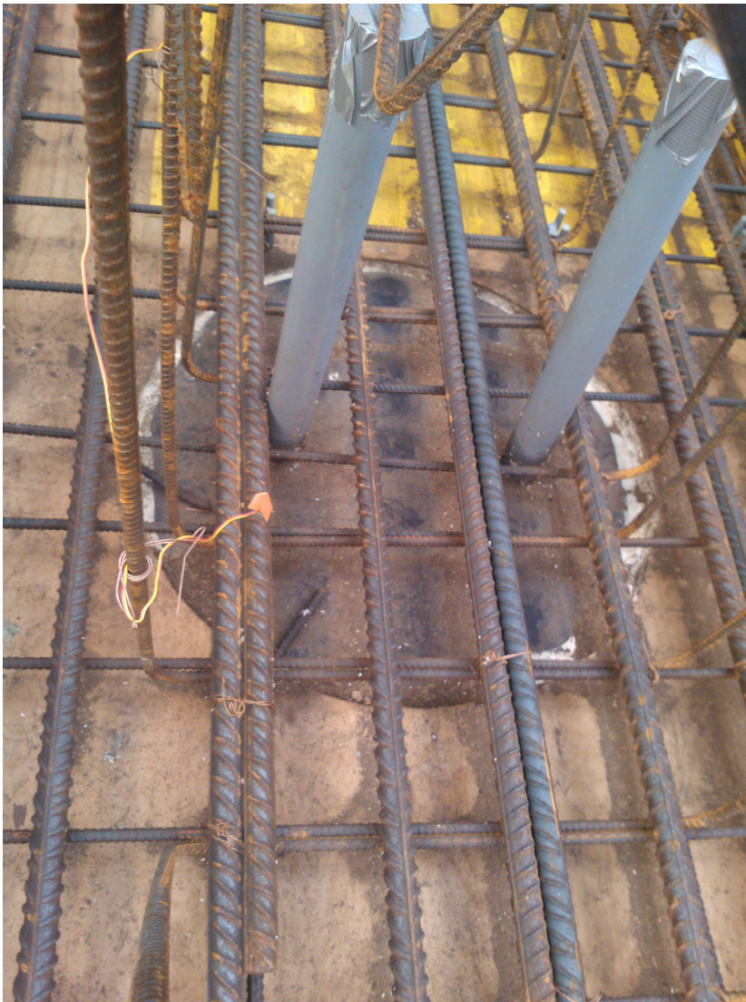
Kuva 4. Pilarin laakerointi ja tappien putkitus Jätkäsaaren työmaa (tässä kohteessa tappeja ei valettu kiinni jälkikäteen, joten putkitus ulotettiin vain 50mm tappien yläpinnasta yli)
