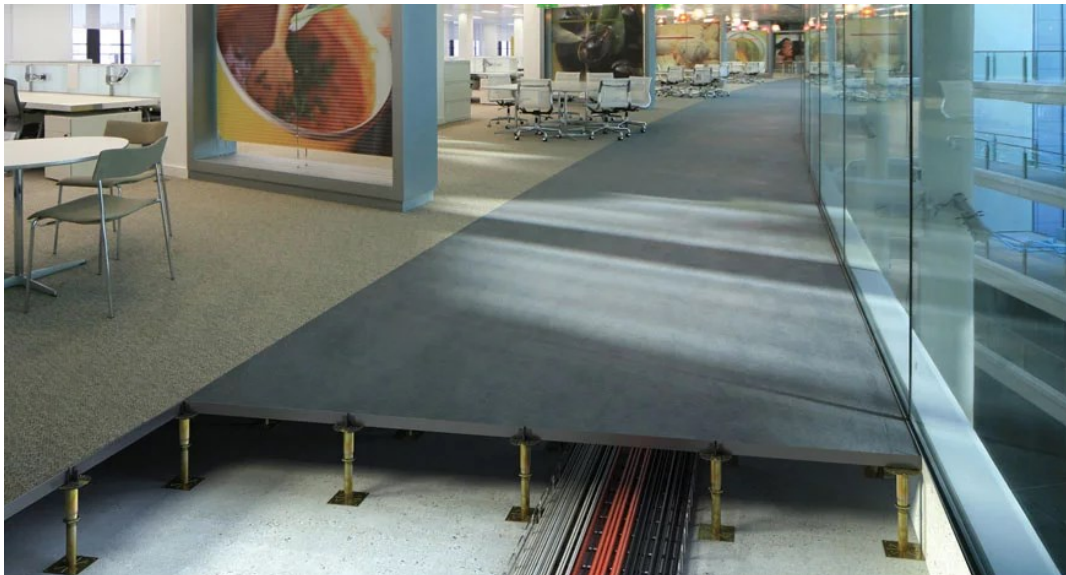
Kuva 1. Esimerkkikuva asennuslattiasta sekä sen alla kulkevasta tekniikasta. (3)
