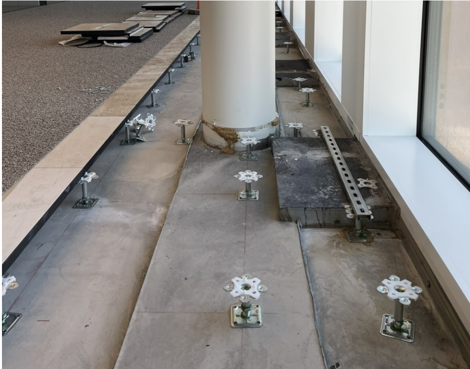
Kuva 21. Asennuslattian jalustojen tiellä olevat palosuojauskoteloinnit.
